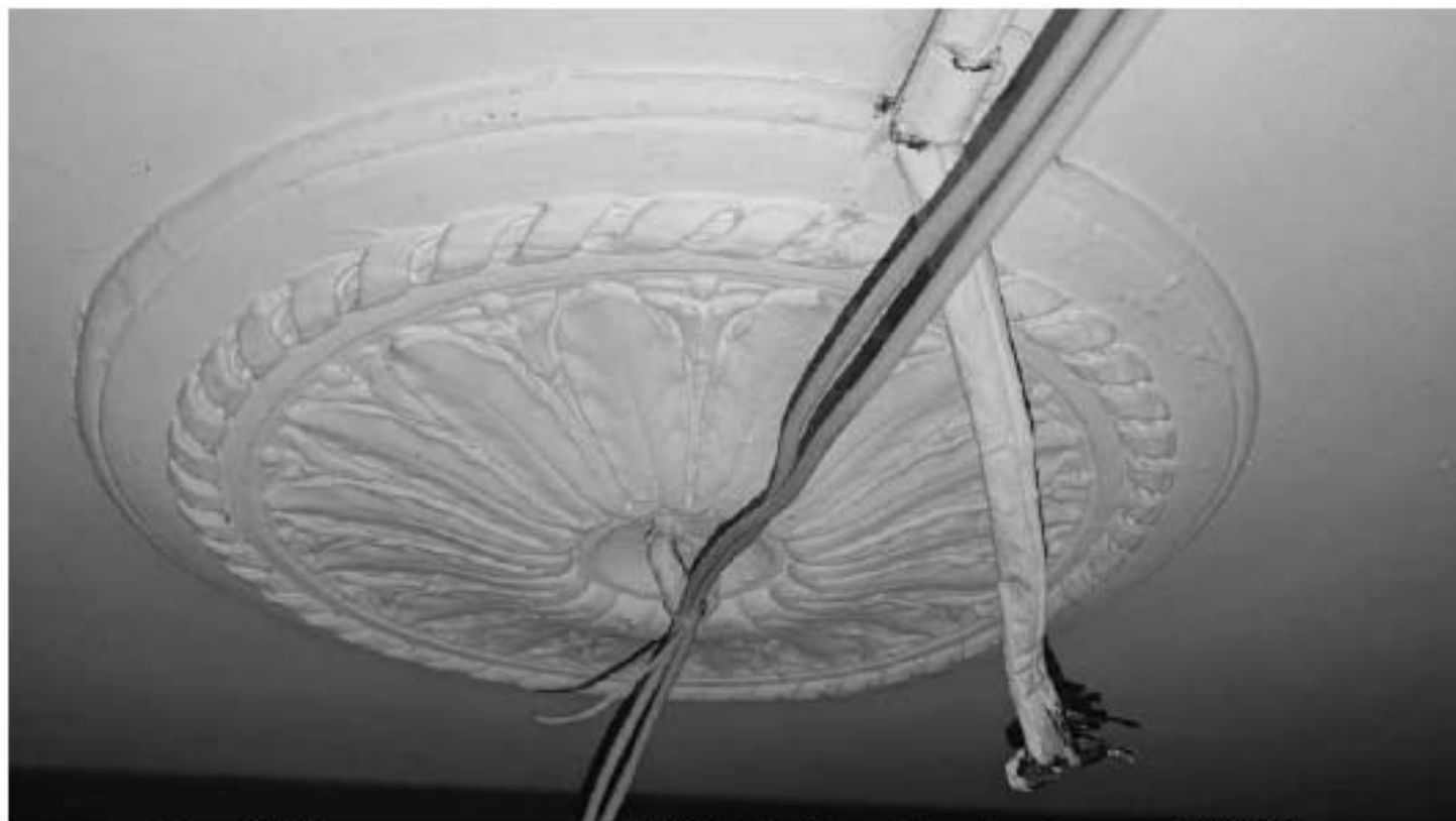
Фото 228. Розетка в помещении 1, 22-Н. Общий вид. Дата фотофиксации: 18.03.25
