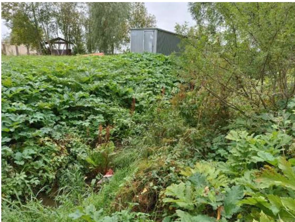
Фото 5. Объект культурного наследия федерального значения «Водовод Виттоловский» (Санкт-Петербург, г. Пушкин, от Виттоловских источников до Екатерининского парка). Общий вид с восточной стороны.
