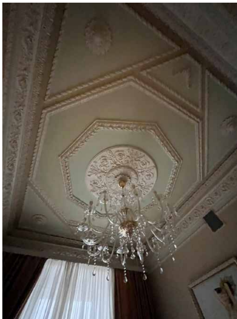
Фото №24. Квартира №263, пом. 16 (потолок).
