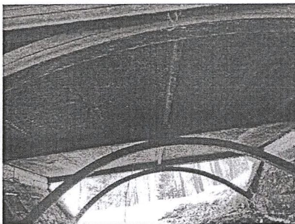
5. Состояние металлических конструкций.
