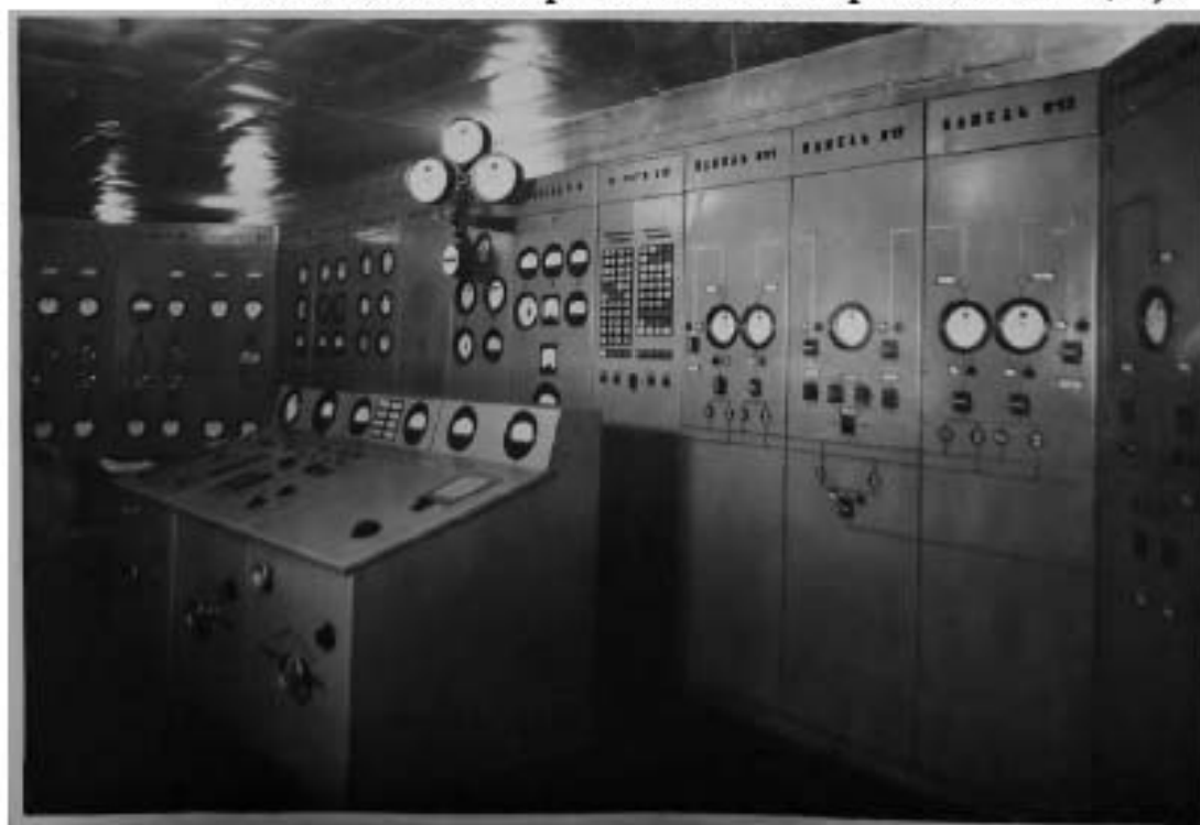
Илл. 110. Главный щит управления. 1954 г. (источник: архив ПАО «ТЭК-1». Ф. 824. Технический паспорт тепловой электрической станции).
