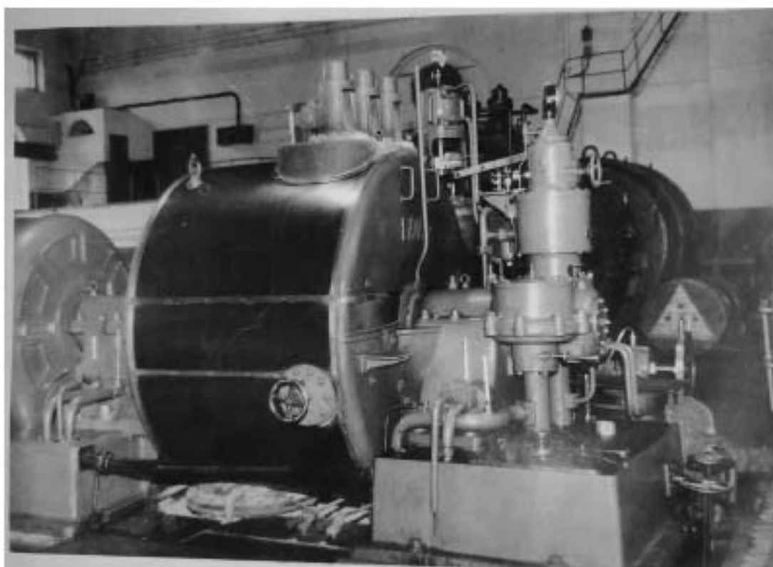
Илл. 107. Турбина № 1 фирмы Лаваль, изготовленная в 1927 г., установленная в 1929 году. Фото 1954 г. (источник: архив ПАО «ТГК-1». Ф. 824. Технический паспорт тепловой электрической станции).
