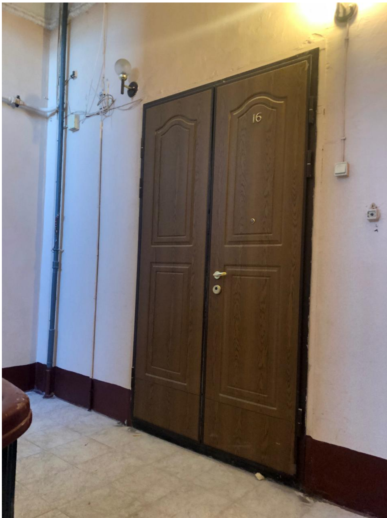
4. Входная дверь в квартиру №16.
