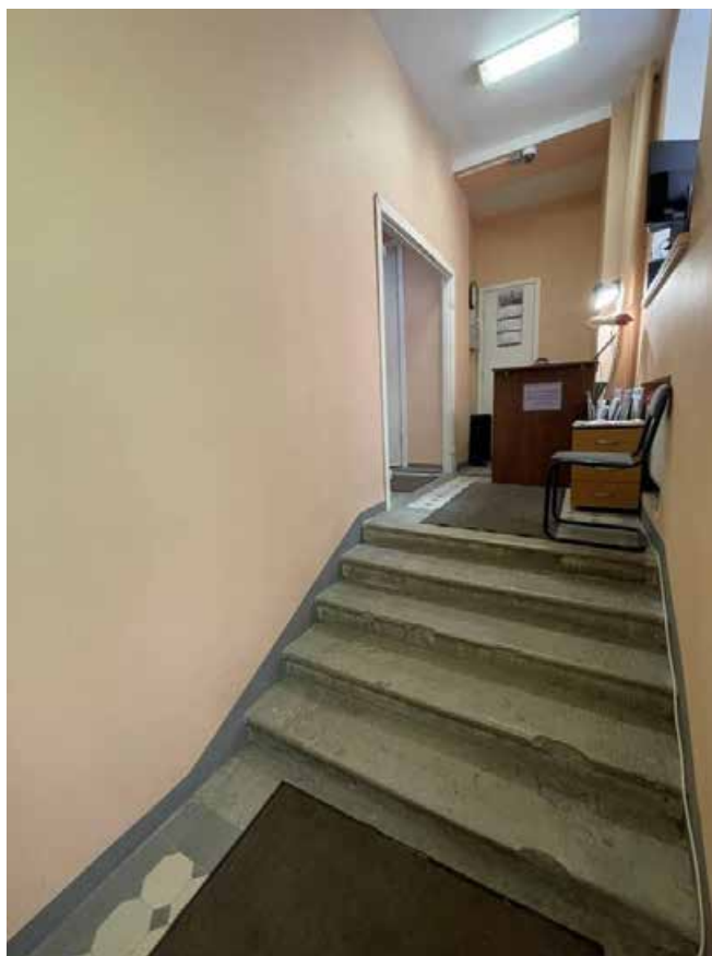
Фото 17. Интерьер лестницы Л-3 выявленного объекта культурного наследия «Городской училищный дом им. Н.В. Гоголя»
