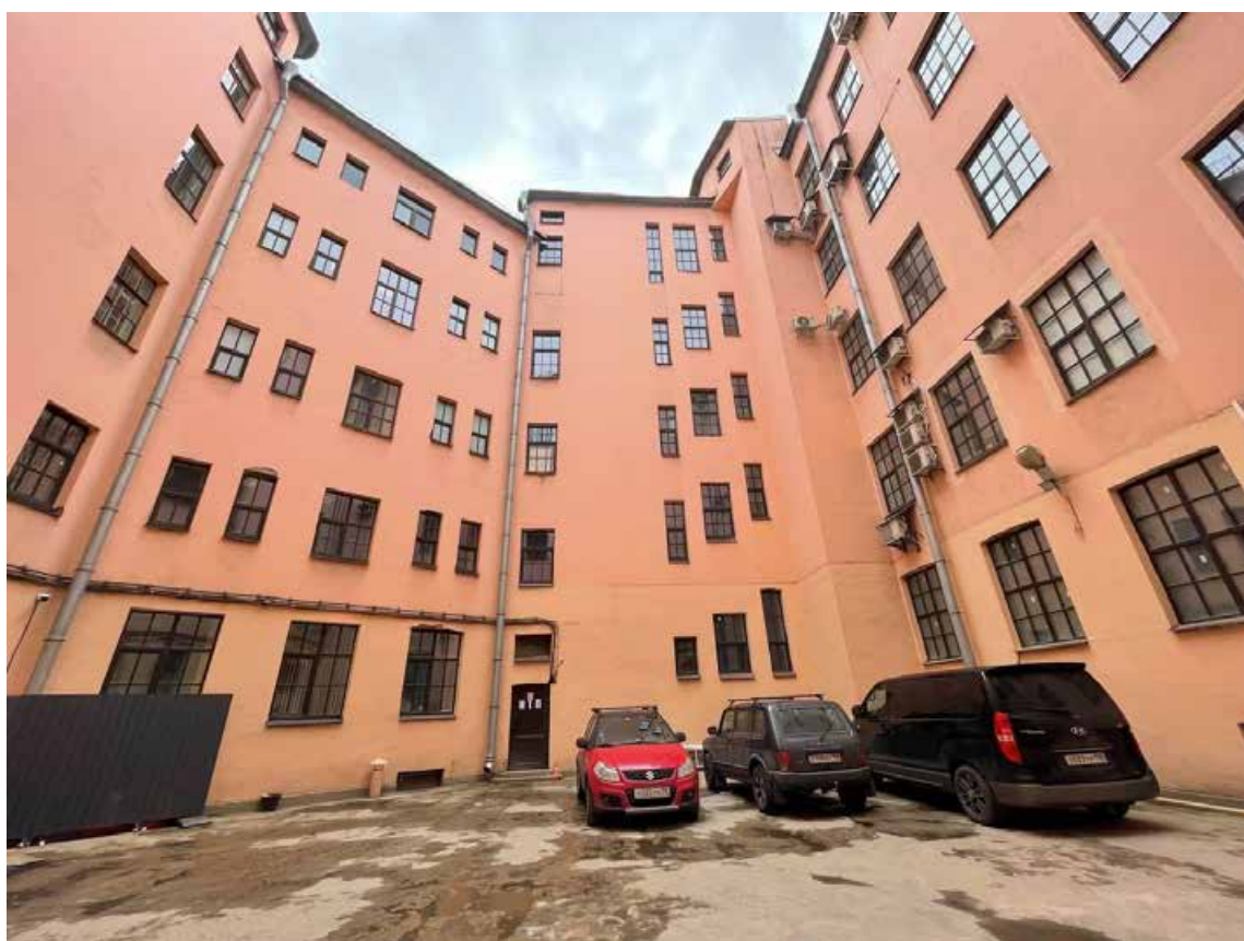
Фото 8. Фрагмент дворового фасада выявленного объекта культурного наследия «Городской училищный дом им. Н.В. Гоголя»
