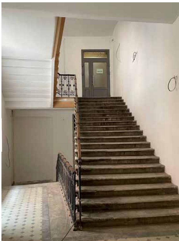
Фото 27. Интерьер лестницы Л-4 выявленного объекта культурного наследия «Городской училищный дом им. Н.В. Гоголя»
