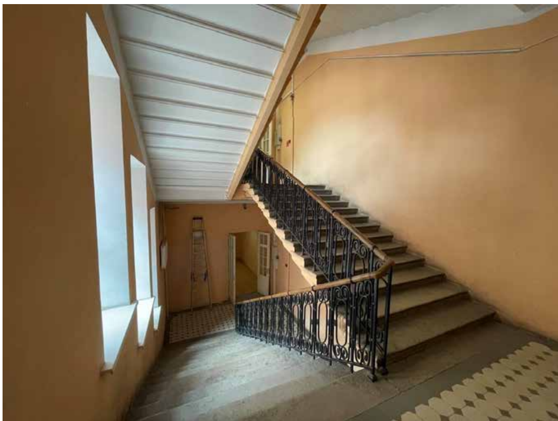
Фото 22. Интерьер лестницы Л-3 выявленного объекта культурного наследия «Городской училищный дом им. Н.В. Гоголя»
