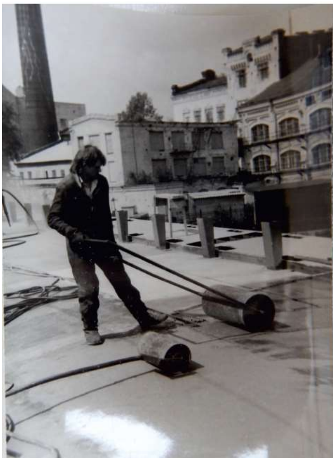
43. Архив СПб ГБУ «Мостотрест». Ф. Екатерингофский мост. Проект капитального ремонта Екатерингофского моста. Фото 1989 г.
