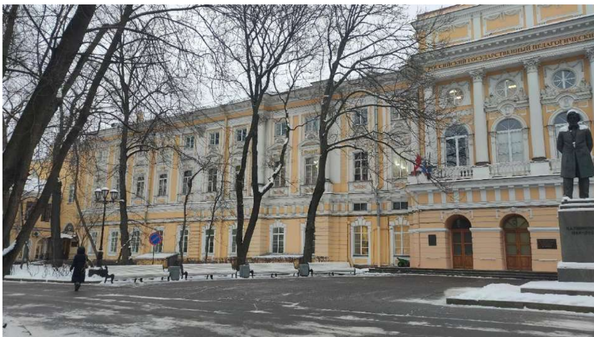
Фото 30. Фрагмент северо-западного фасада объекта культурного наследия федерального значения «Дворец Разумовского К.Г. Никольский сиротский институт», входящего в состав объекта культурного наследия федерального значения «Воспитательный дом Императорский», расположенный по адресу: Санкт-Петербург, наб. р. Мойки, д. 48, лит. А, корп. 5
