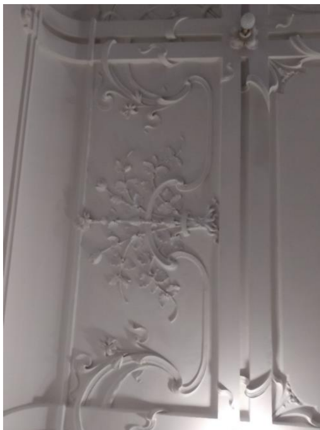
Фото 19. Фрагмент потолка в пом. № 2.
