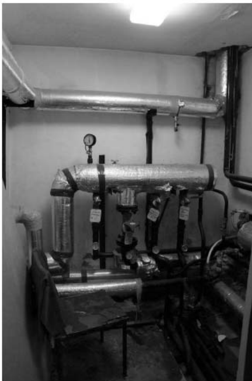
Фото 14. 2-Н (7) - Водомерный узел
