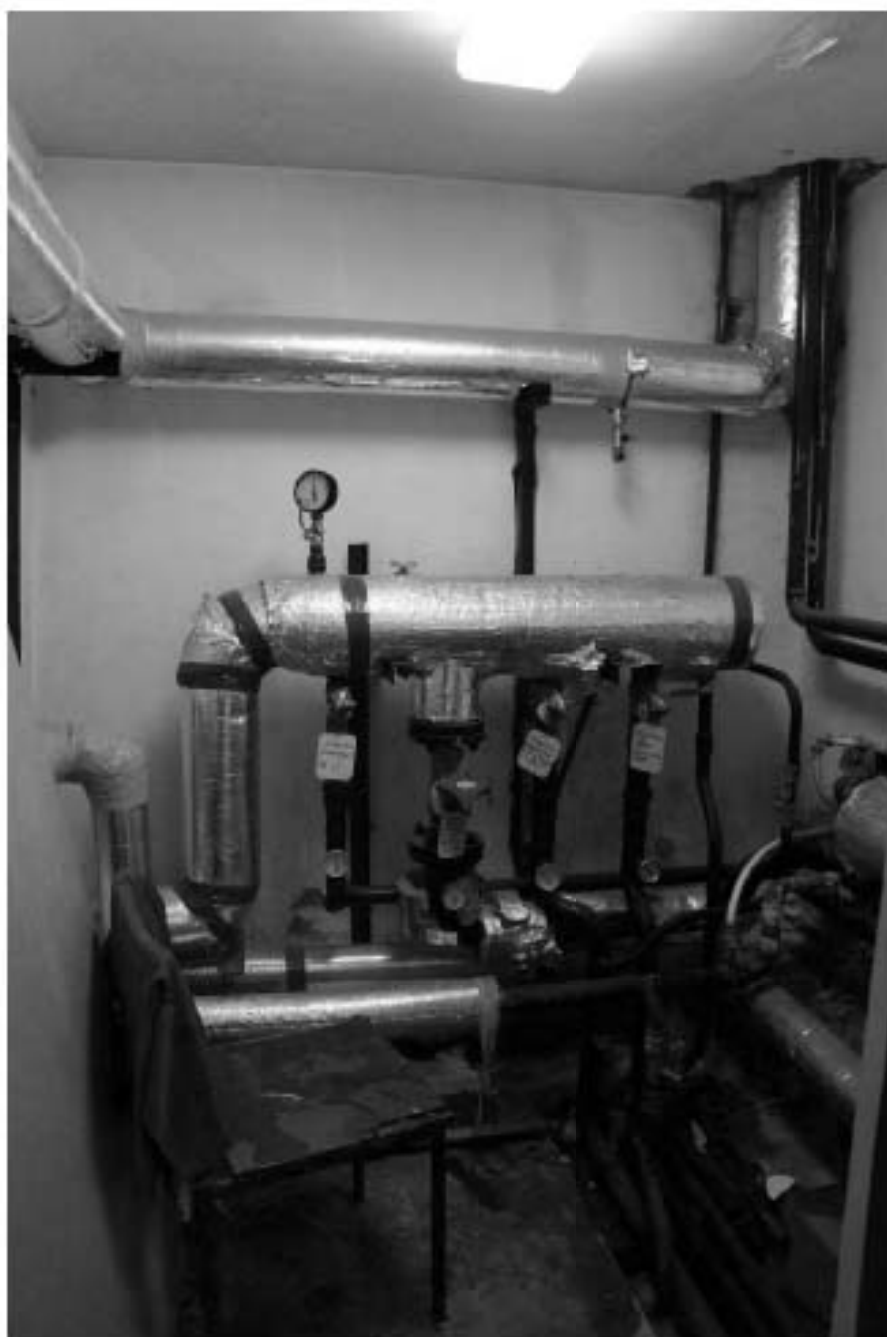
Фото 14. 2-Н (7) - Водомерный узел
