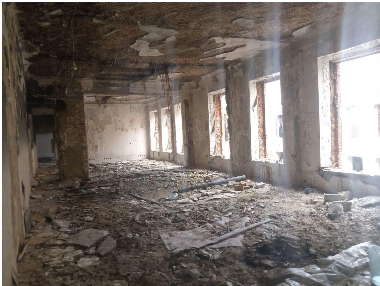
Фото 53. Помещение ЗН(15-20) Общий вид.
