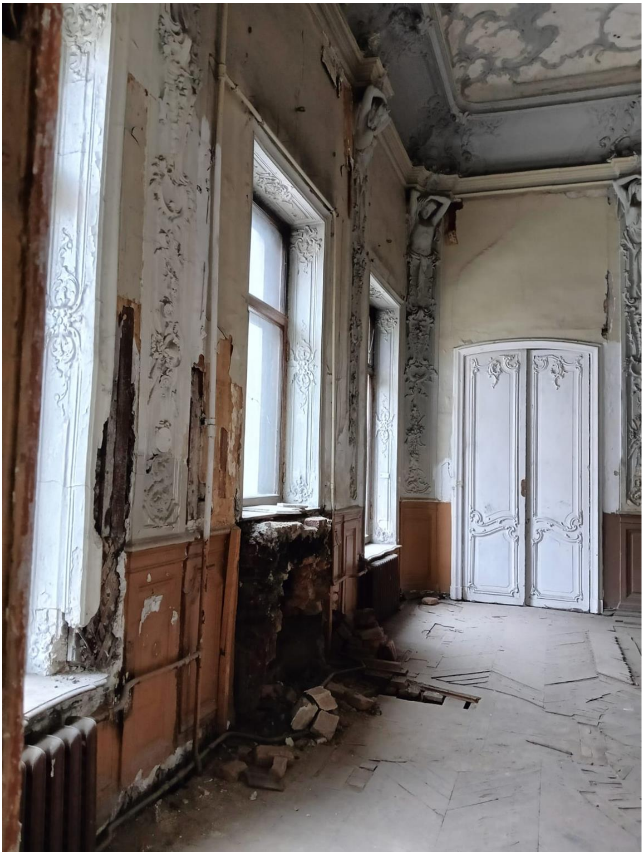
Фото 38. Помещение ЗН(9) (Мифологический зал). Вид на помещение ЗН(10). Вывалы кирпичной кладки на месте камина, дымохода.
