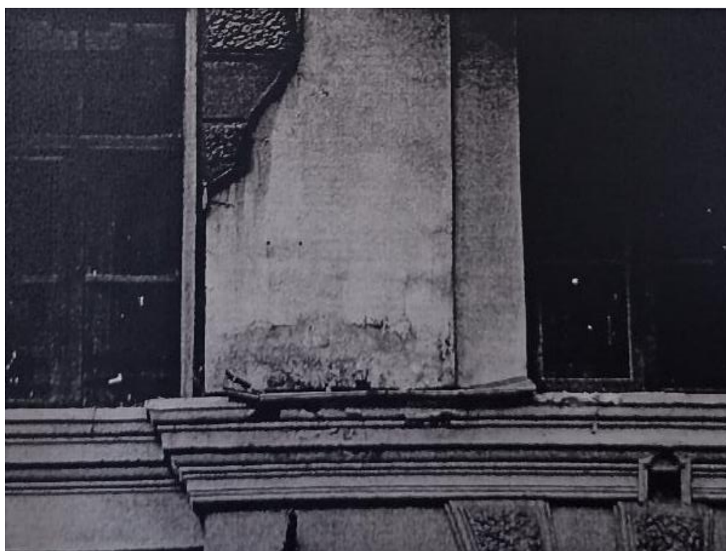
31. Дефекты лицевого фасада. Фото 2004 г. Архив КГИОП. Акт оценки технического состояния по внешним признакам дефектов и повреждений от 07 июня 2004 года. СПб., 2004. Раздел «Фотофиксация».
