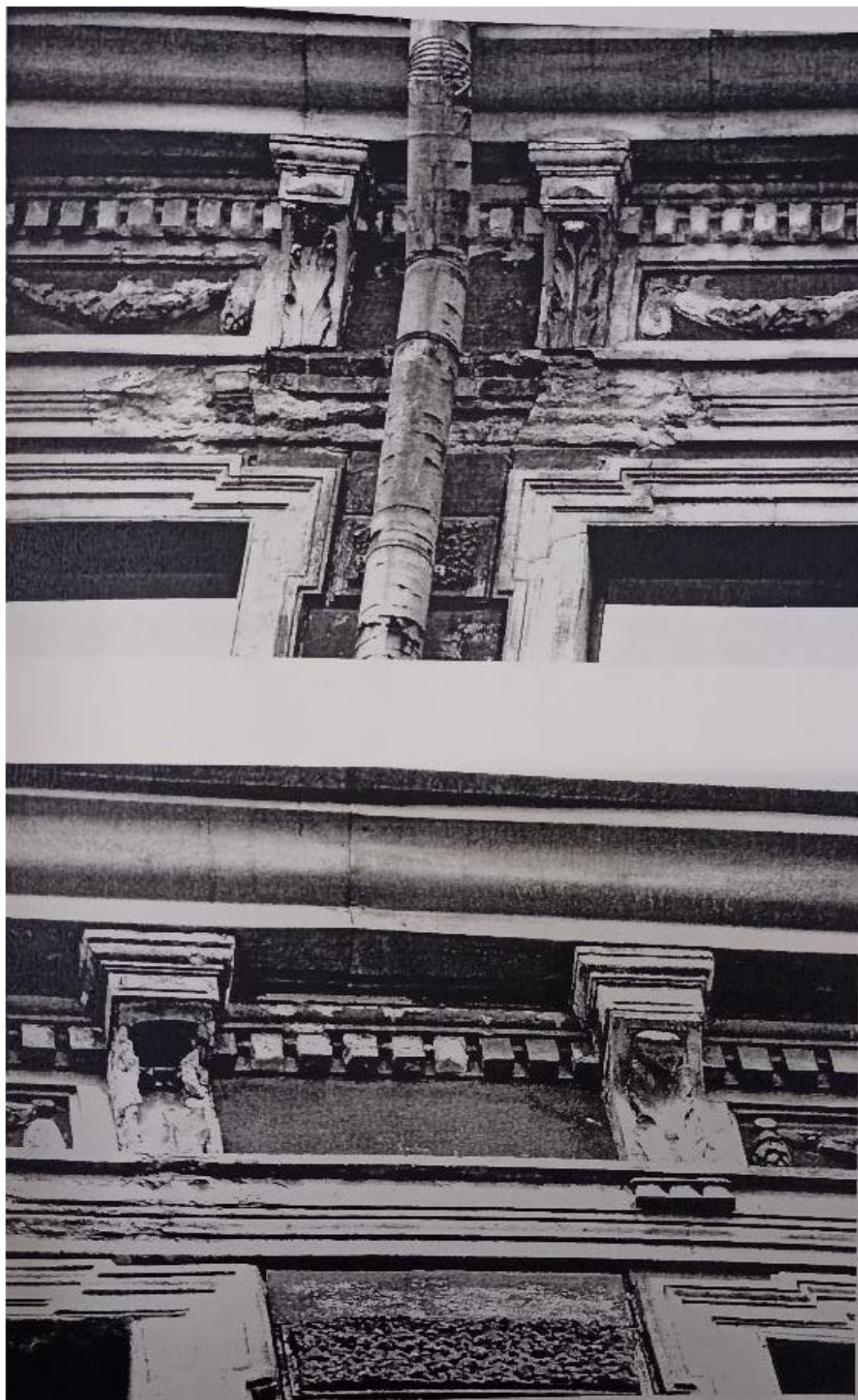
32. Дефекты лицевого фасада. Фото 2004 г. Архив КГИОП. Акт оценки технического состояния по внешним признакам дефектов и повреждений от 07 июня 2004 года. СПб., 2004. Раздел «Фотофиксация».
