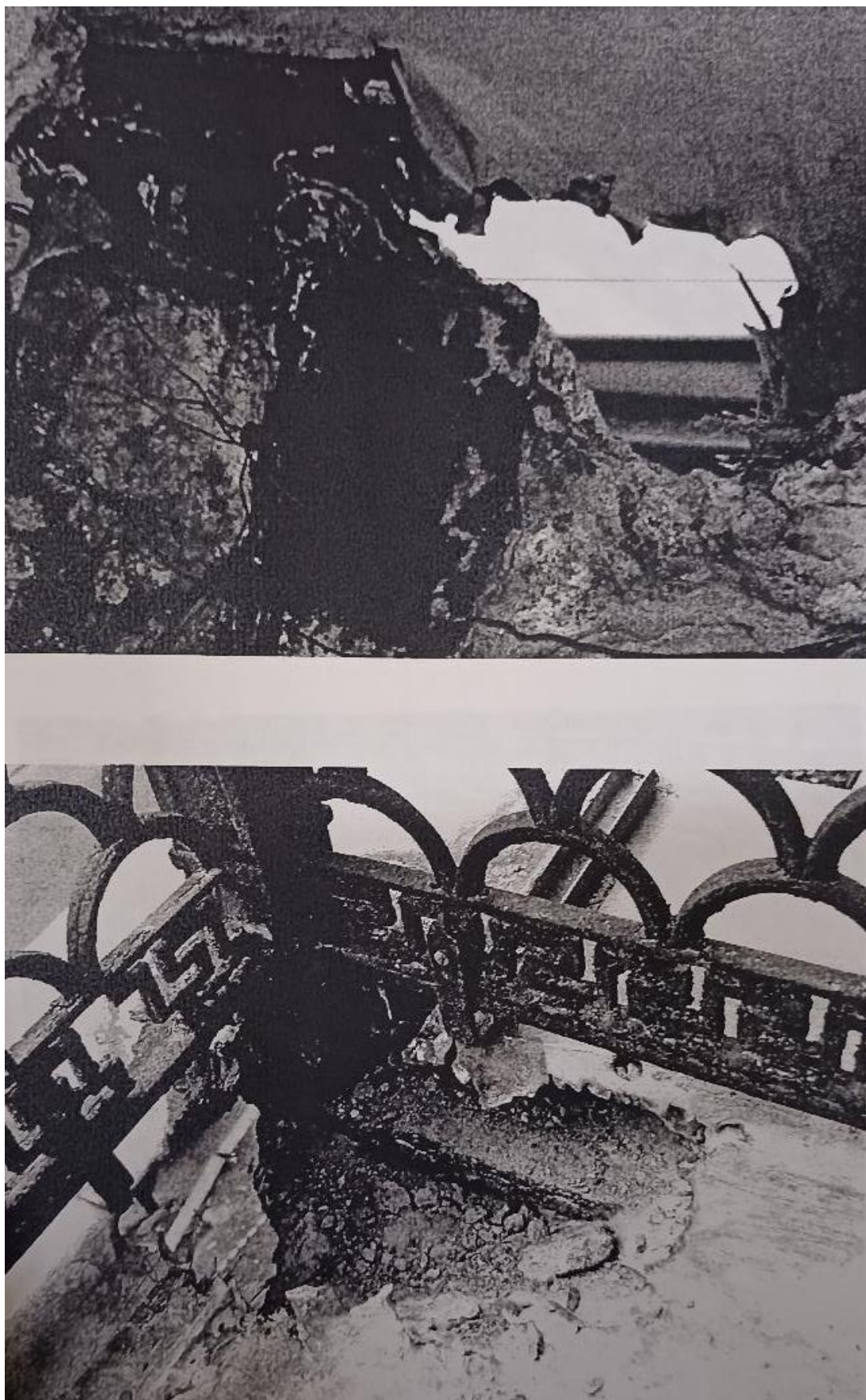
34. Дефекты лицевого фасада. Фото 2004 г. Архив КГИОП. Акт оценки технического состояния по внешним признакам дефектов и повреждений от 07 июня 2004 года. СПб., 2004. Раздел «Фотофиксация».
