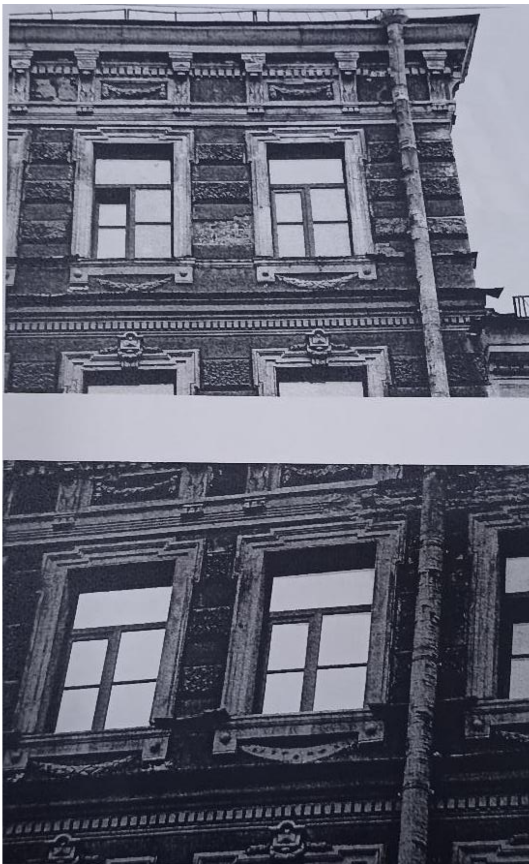
33. Дефекты лицевого фасада. Фото 2004 г. Архив КГИОП. Акт оценки технического состояния по внешним признакам дефектов и повреждений от 07 июня 2004 года. СПб., 2004. Раздел «Фотофиксация».
