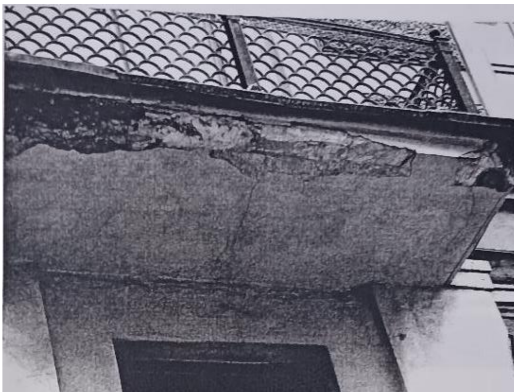
30. Дефекты лицевого фасада. Фото 2004 г. Архив КГИОП. Акт оценки технического состояния по внешним признакам дефектов и повреждений от 07 июня 2004 года. СПб., 2004. Раздел «Фотофиксация».
