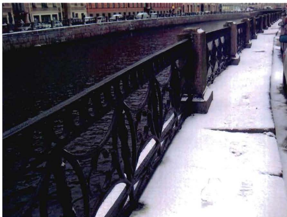
10. Перильное ограждение, тротуар (правый берег, на участке между Певческим и Полицейским (Зелёным, Народным) мостами)
