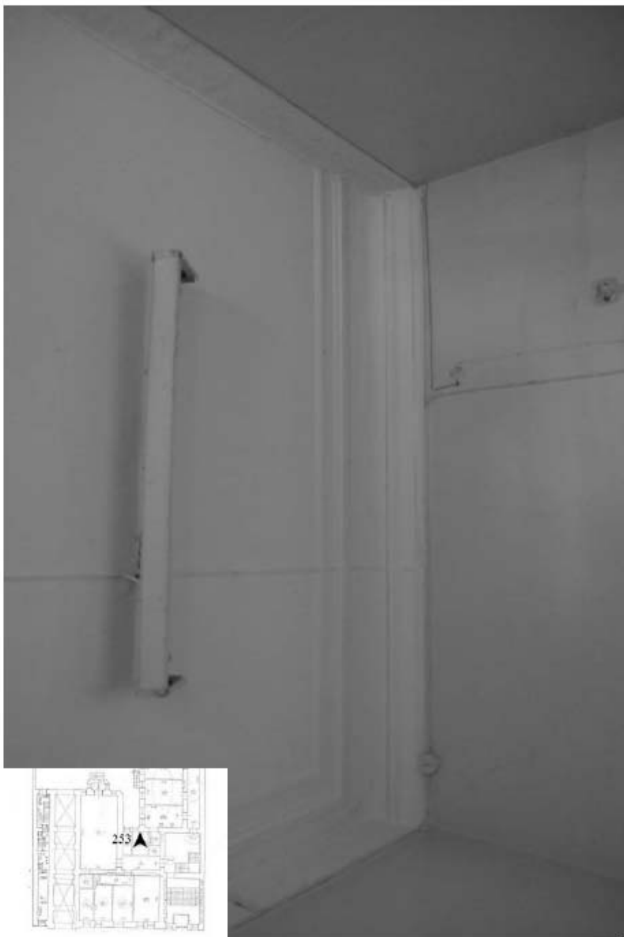
253. Этаж 1, помещение 20-Н. Потолок комнаты 10,3 кв.м.
