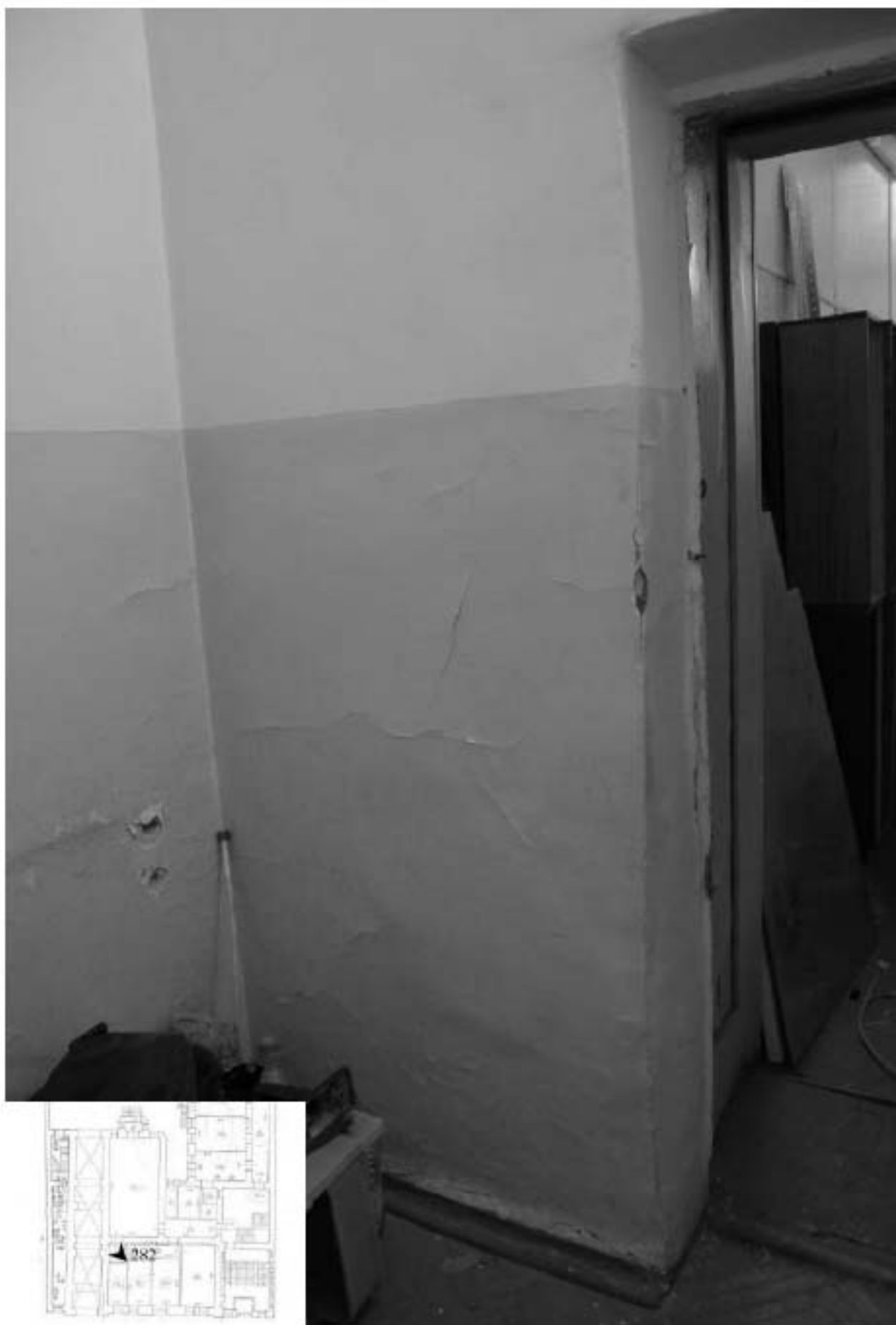
282. Этаж 1, помещение 20-Н. Потолок комнаты 4,7 кв.м.
