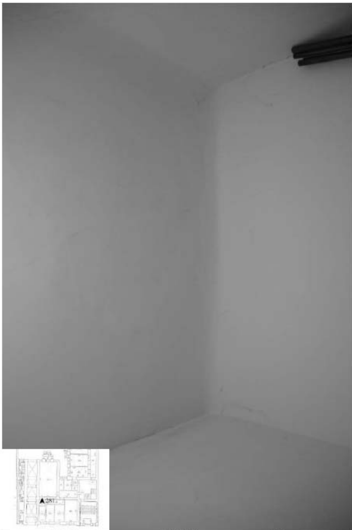
281. Этаж 1, помещение 20-Н. Потолок комнаты 4,7 кв.м.
