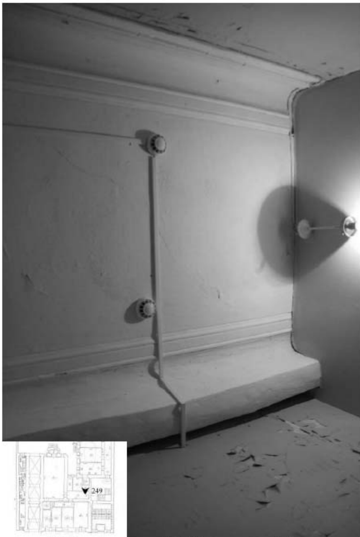
249. Этаж 1, помещение 20-Н. Потолок комнаты 3,6 кв.м.
