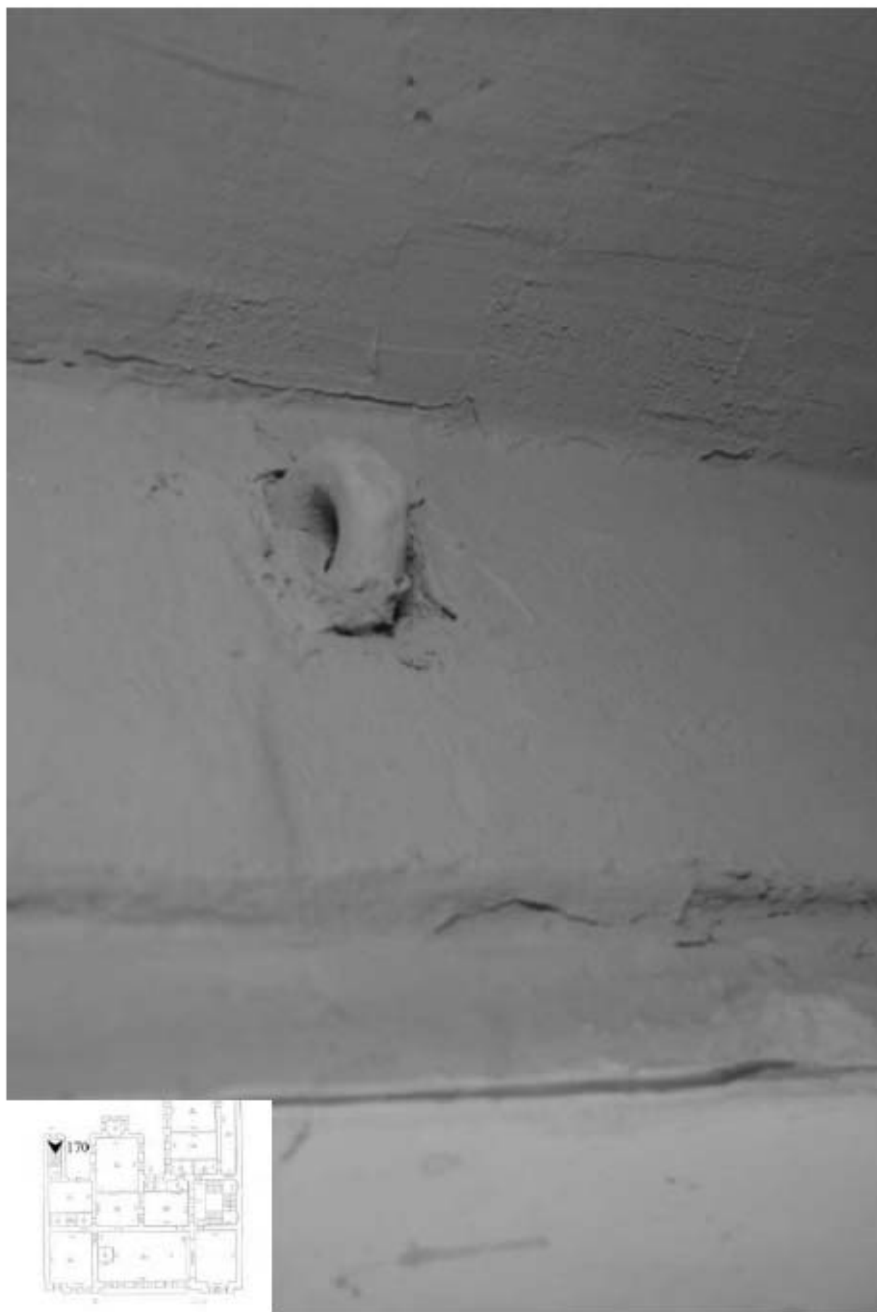
170. Лестница 2ЛК. Петли ставней на площадке между 2 и 3 этажами.
