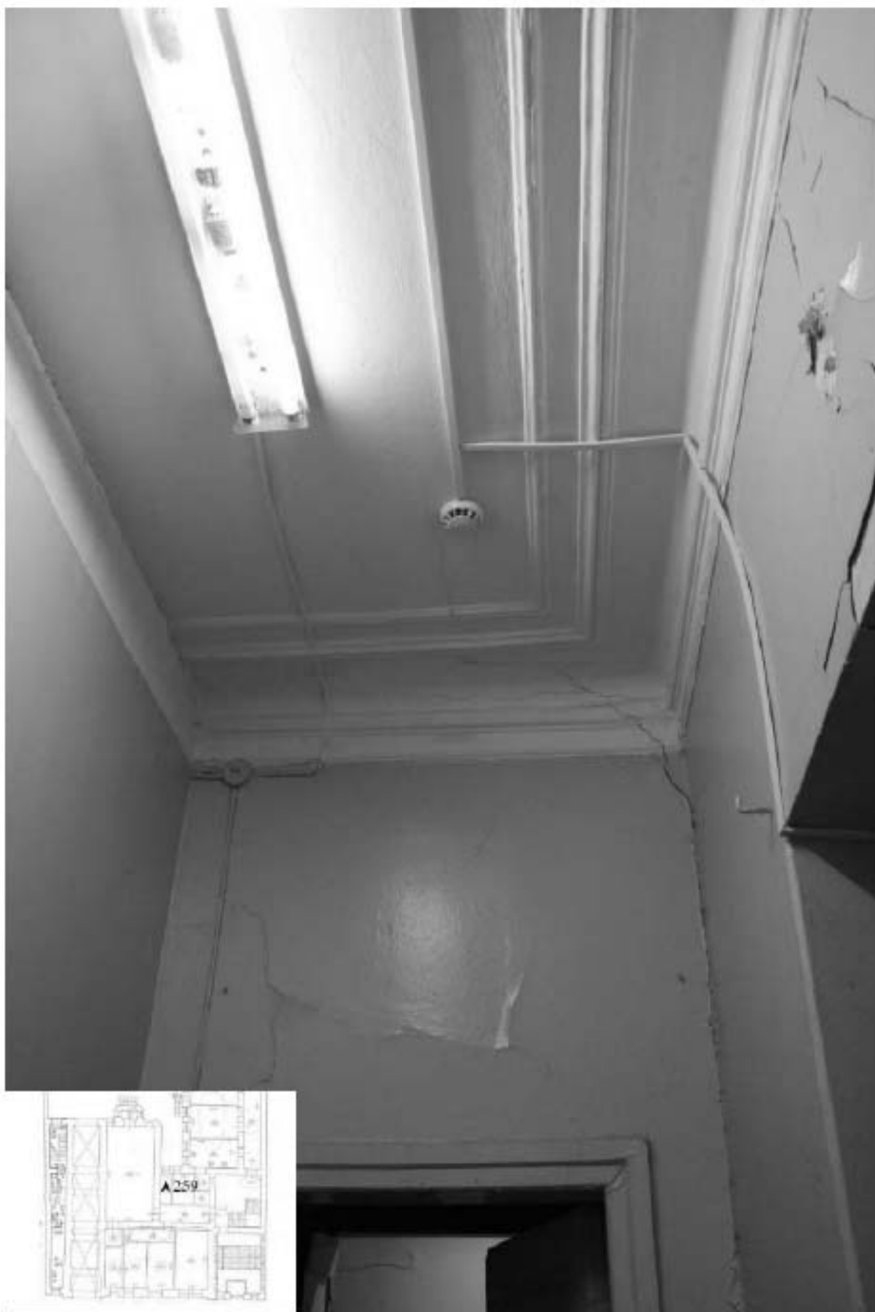
259. Этаж 1, помещение 20-Н. Потолок комнаты 5,6 кв.м.
