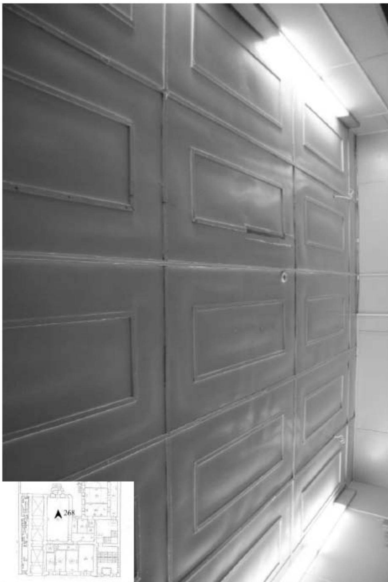
268. Этаж 1, помещение 20-Н. Потолок зала 75,3 кв.м.
