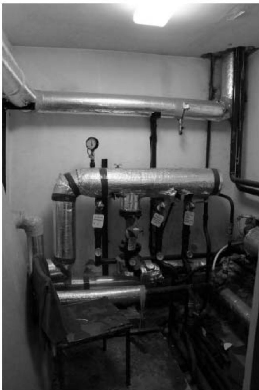
Фото 14. 2-Н (7) - Водомерный узел
