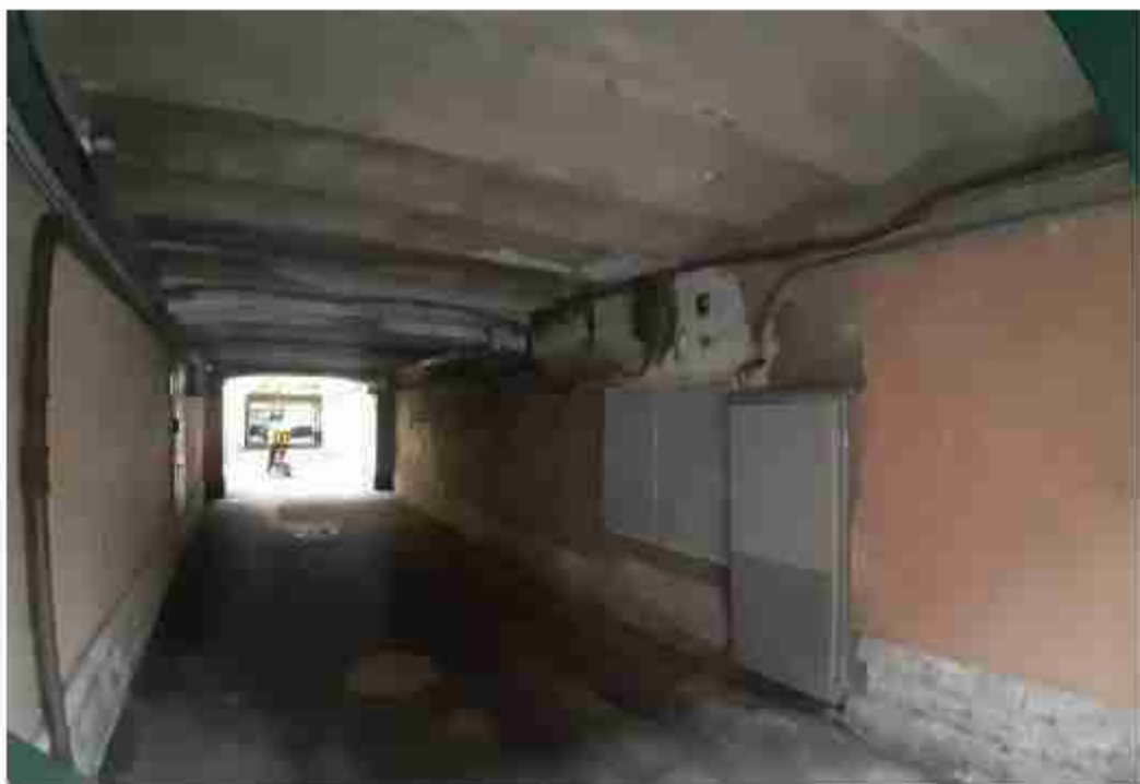
37. «Доходный дом» (в составе «Доходные дома Н.И. Львовой (А.Д. Сивкова)» (Угловой пер., д. 9, лит. А). Арочный проезд. Фото мест установки оборудования и кабельных трасс. Штиглиц М.С. 26.12.2024.
