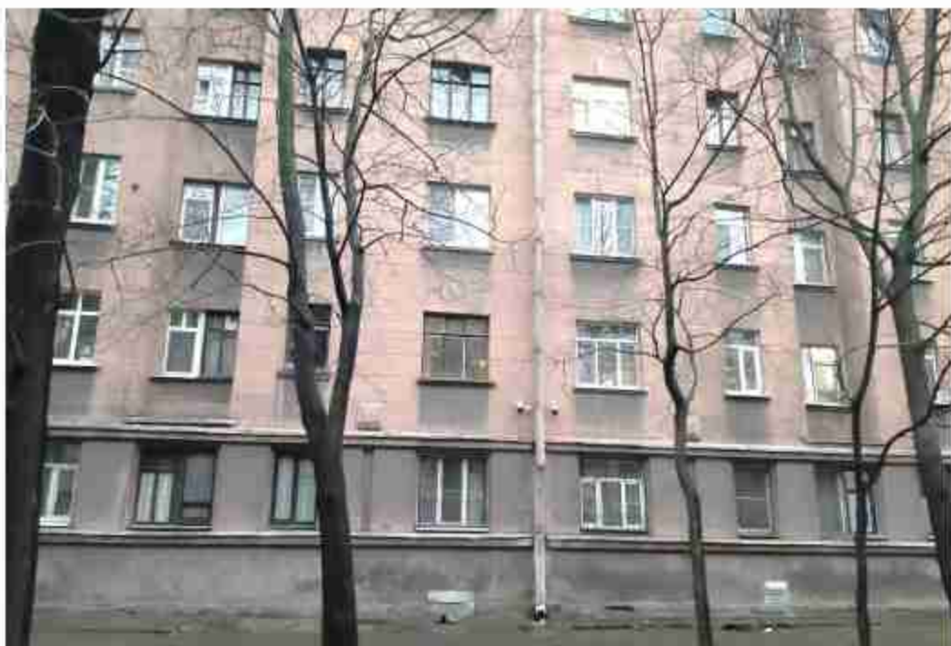
51. «Жилой дом работников Союзверфи» (Декабристов ул., д. 29, лит. Б). Лицевой фасад (фрагмент). Фото мест установки оборудования и кабельных трасс. Штиглиц М.С. 26.12.2024.
