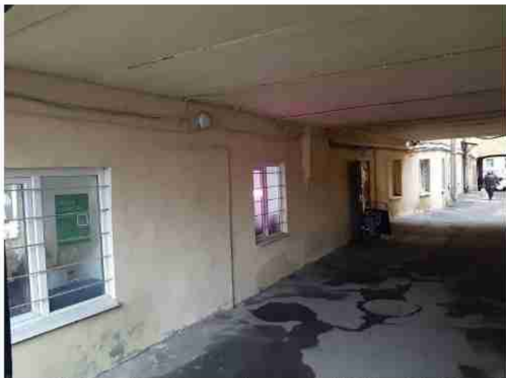
35. «Доходный дом» (в составе «Доходные дома Н.И. Львовой (А.Д. Сивкова)) (Угловой пер., д. 9, лит. А). Арочный проезд. Фото мест установки оборудования и кабельных трасс. Штиглиц М.С. 26.12.2024.
