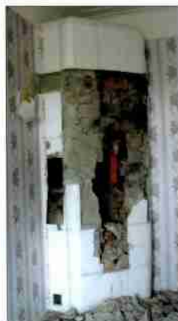
30. Печка угловая (помещение № 3, площадью 15,7 кв. м, вдоль лицевой фасада). Пятый этаж.
