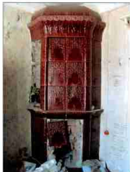
35. Печь (помещение № 4). Шестой этаж.
