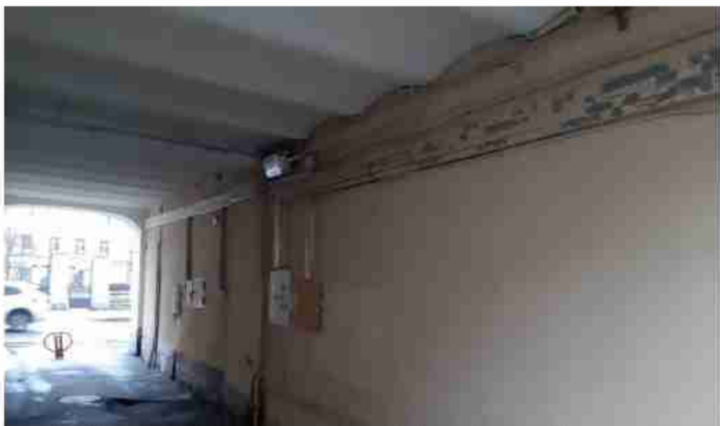
23. «Жилой дом» (Пасторова ул., д. 7, лит. А). Аро́чный проезд. Фото мест установки оборудования и кабельных трасс. Штиглиц М.С. 26.12.2024.
