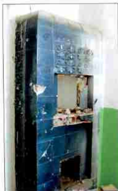
32. Печь (помещение № 5). Пятый этаж.
