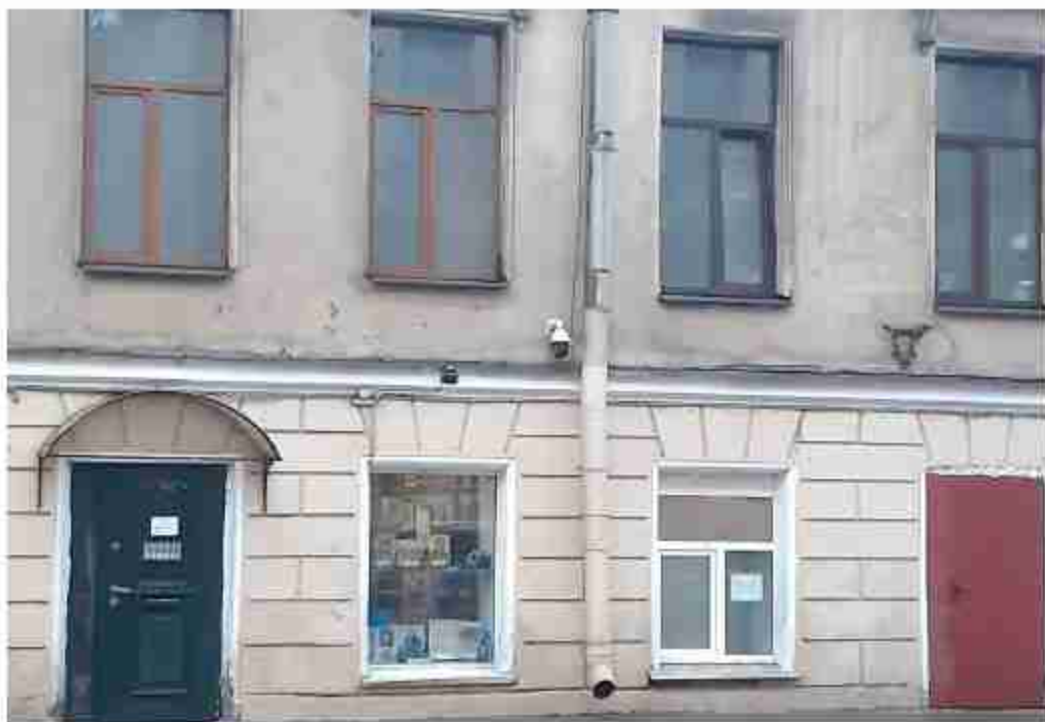
49. «Жилой дом» (Старо-Петергофский пр., д. 3-5, лит. А). Лицевой фасад (фрагмент). Фото мест установки оборудования и кабельных трасс. Штиглиц М.С. 26.12.2024.
