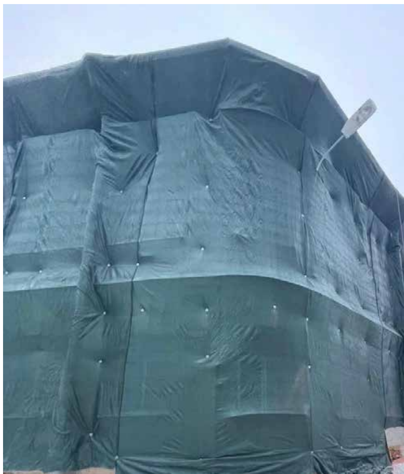
Фото 1. Общий вид на пересечении Масляного канала и Кожевенной линии. В соответствии с первоочередными противоаварийными мероприятиями, разработаны противоаварийные мероприятия по фасадным стенам. В настоящее время, на фасады здания установлены защитные укрывные сетки.
