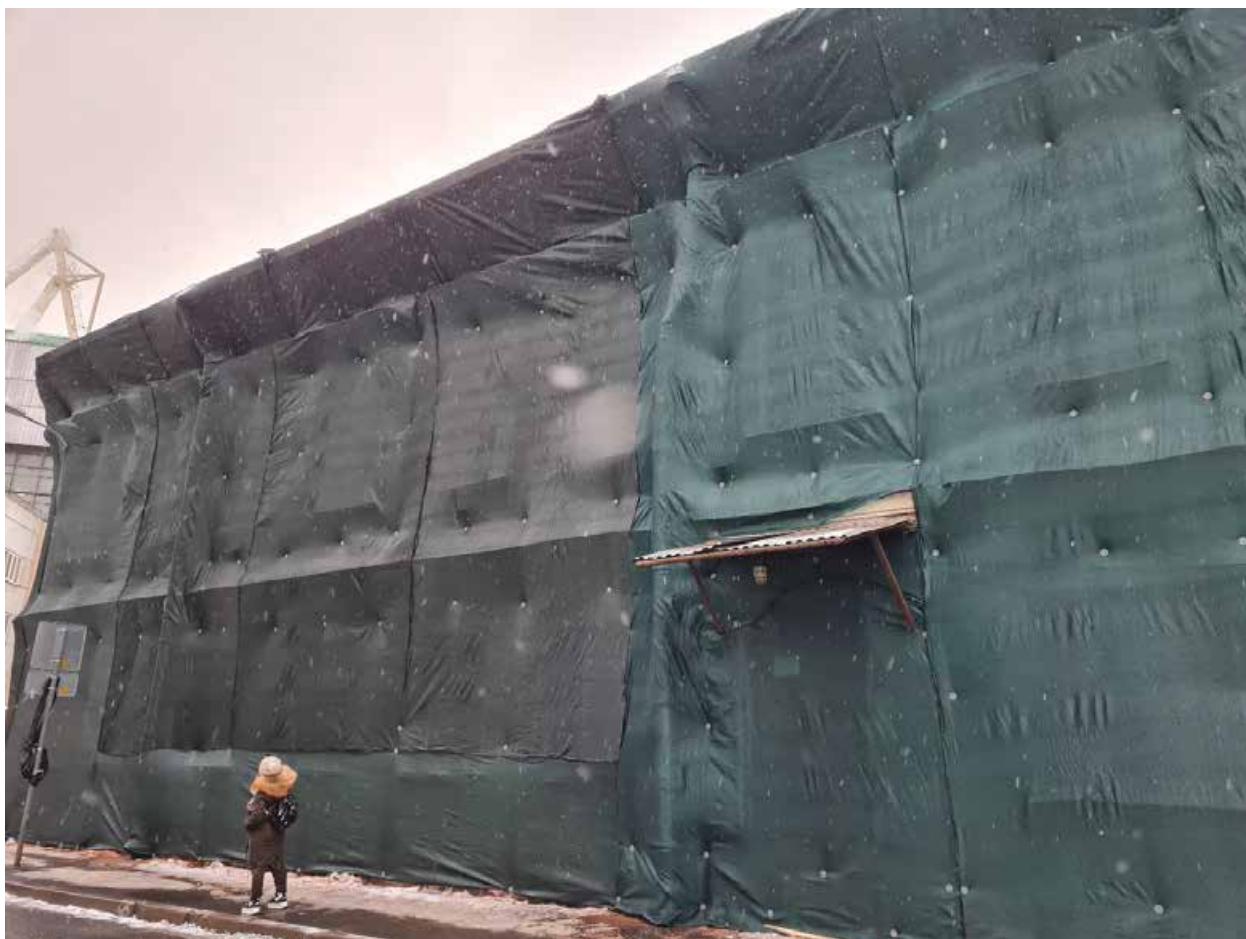
Фото 3. Фрагмент фасада вдоль Масляного канала. В настоящее время, на фасады здания установлены защитные укрывные сетки.
