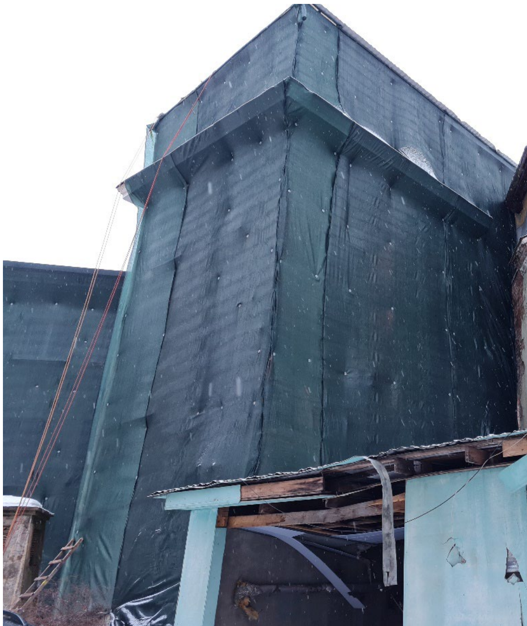
Фото 7. Фрагмент дворового (юго-западного) фасада. В настоящее время, на фасады здания установлены защитные укрывные сетки.
