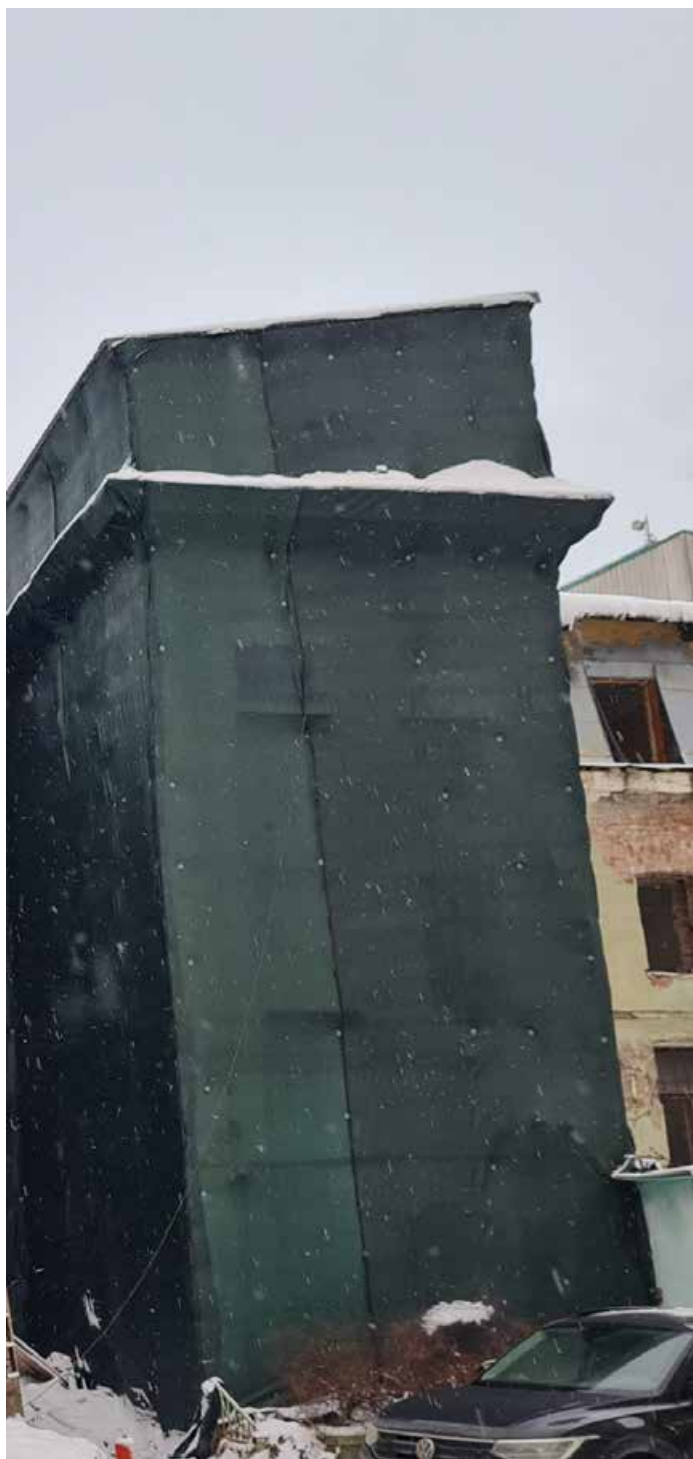
Фото 6. Фрагмент дворового (юго-западного) фасада. В настоящее время, на фасады здания установлены защитные укрывные сетки.
