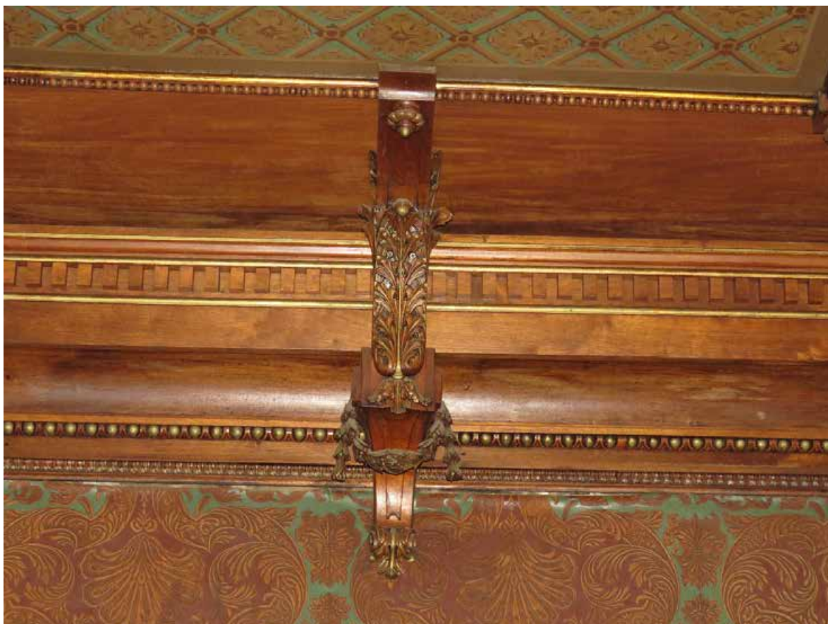
Фото 29. 2 этаж. Помещение 1-Н (№ 57). Кронштейн потолочного карниза.
