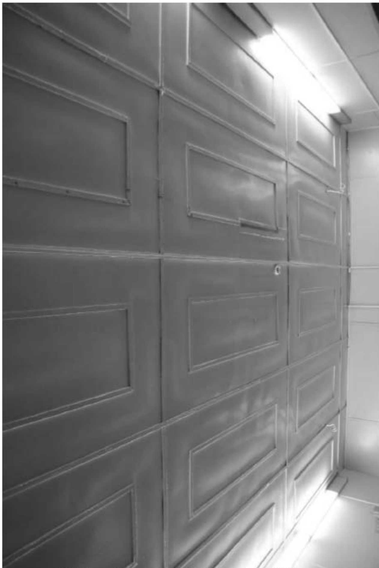
268. Этаж 1, помещение 20-Н. Потолок зала 75,3 кв.м.
