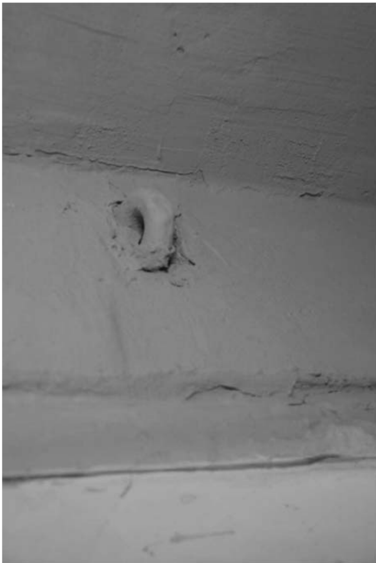
670. Лестница 2ЛК. Петли ставней на площадке между 2 и 3 этажами.
