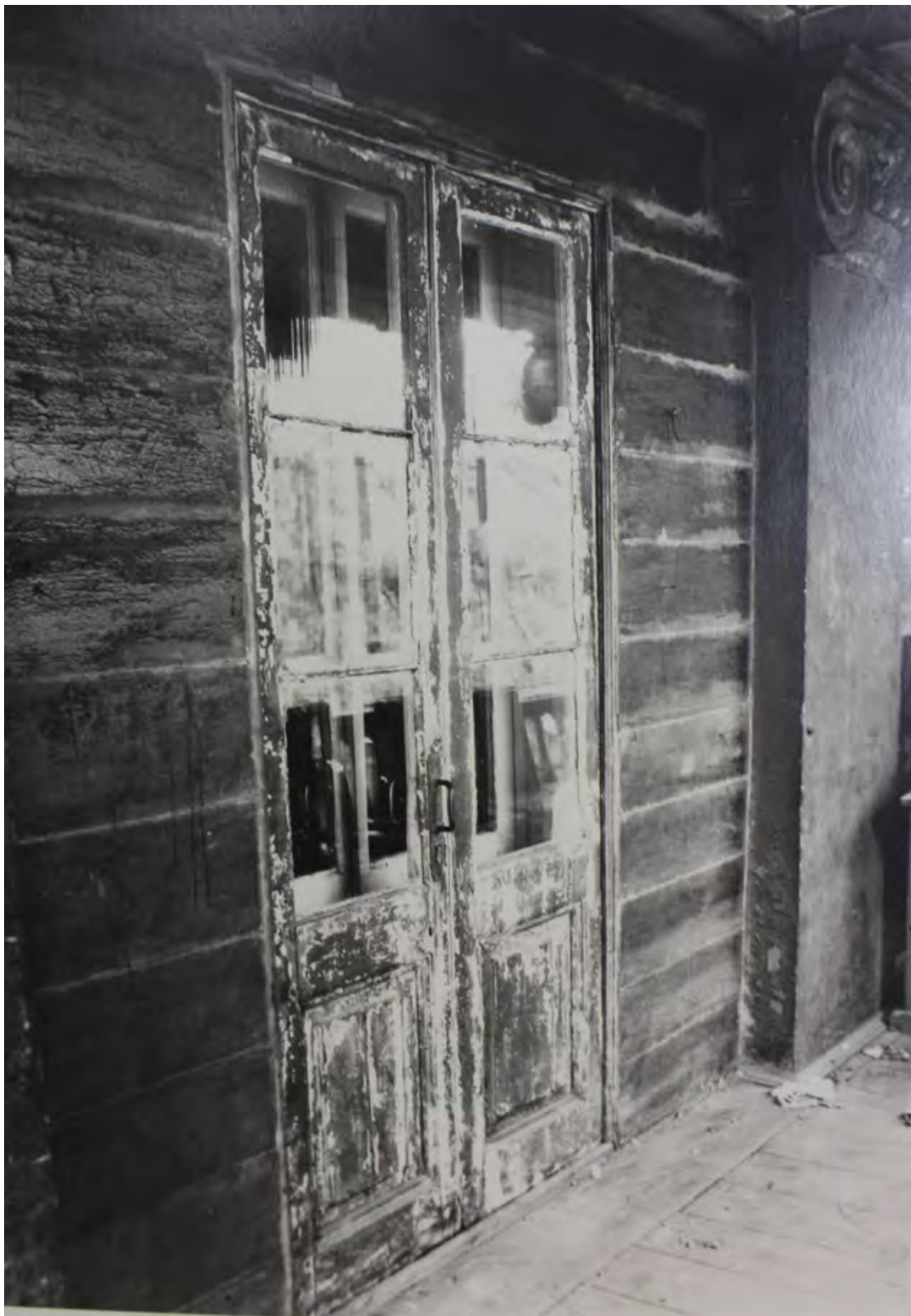
103. Дача Головина. Балконная дверь с оригинальной расстекловкой. 1961 г. // ЦГА НТД СПб. Ф. 488. Оп. 3-13. Д. 15. Л. 19.
