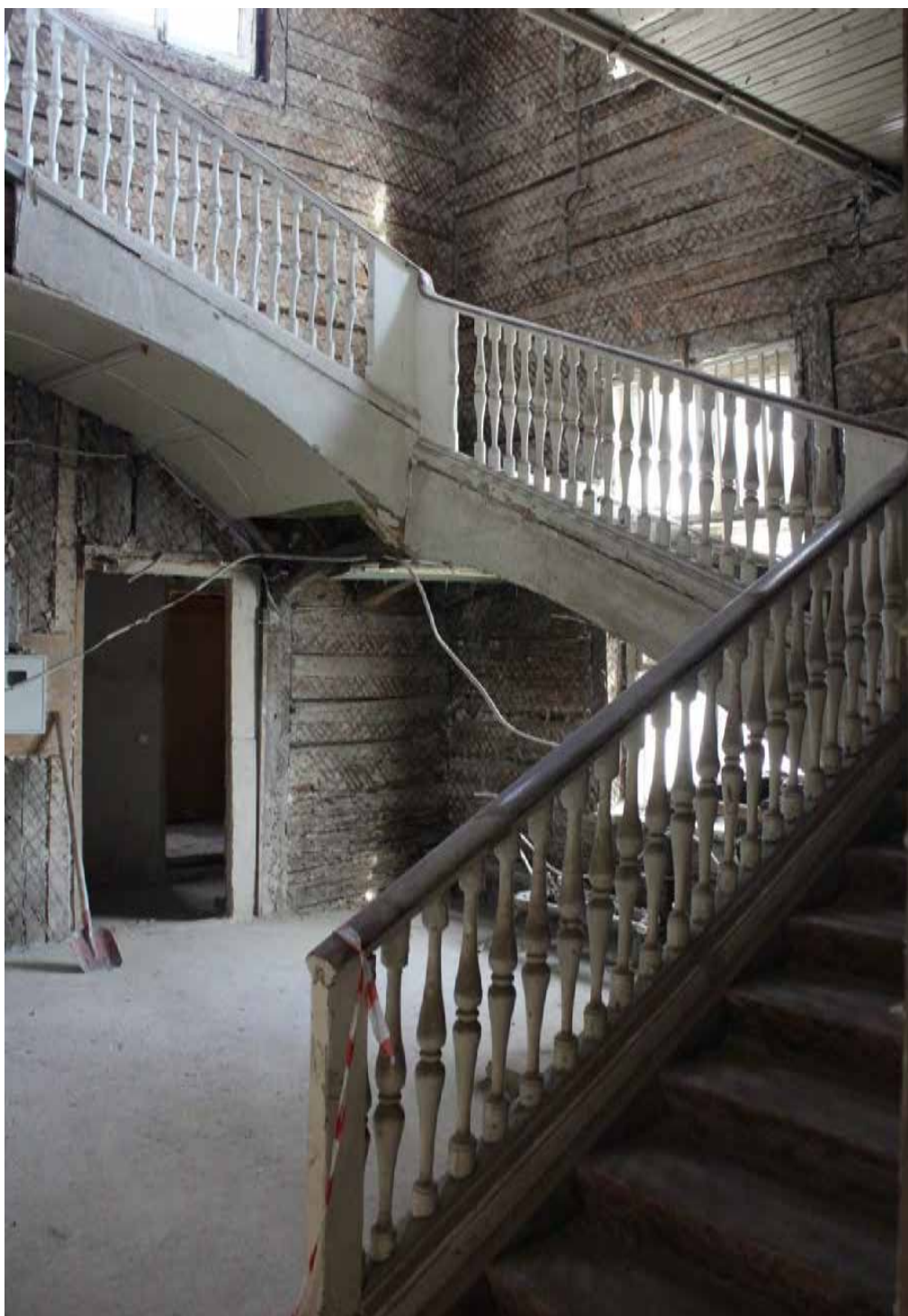
29. Объект культурного наследия федерального значения «Дача Головина» по адресу: Выборгская наб., д. 63, лит. А. 1 этаж, пом. 33. Общий вид бывш. парадной лестницы (ЛК-2). Дата съемки: 07.04.2025
