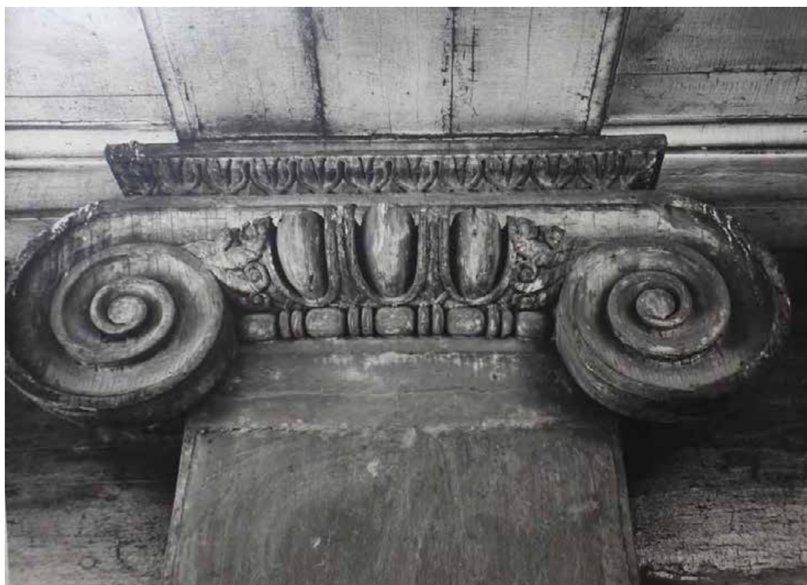
97. Дача Головина. Капитель пилястры. 1961 г. // ЦГА НТД СПб. Ф. 488. Оп. 3-13. Д. 15. Лл. 22, 23.
