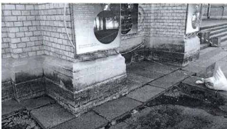
Фото 4. Состояние цоколя северного фасада объект культурного наследия
