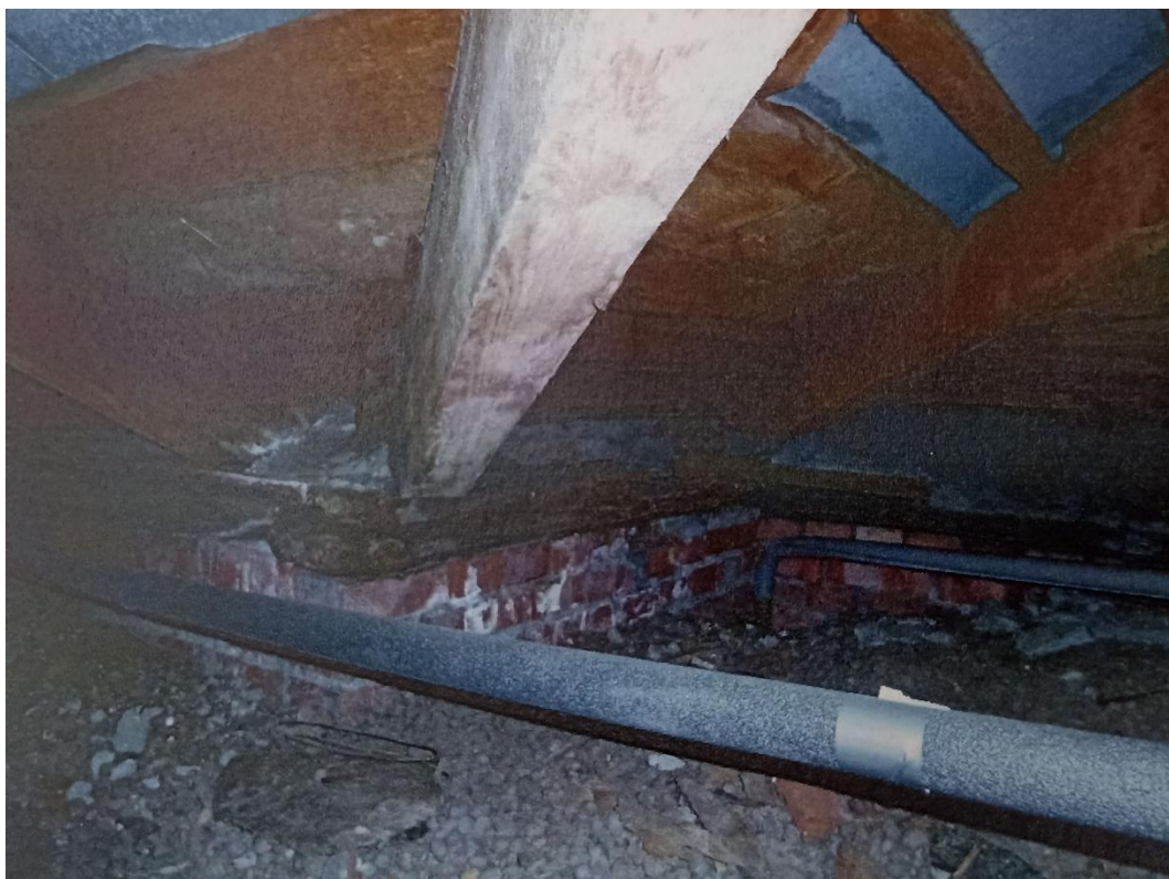
34. Вид стропильных ног на наружную стену через деревянные дощатые прокладки, не имеющих крепления между собой и анкеровки к стенам. Архив КГИОП. Заключение по результатам технического обследования конструкций крыши здания. Разработано ЗАО «Стройком». 2012 г.
