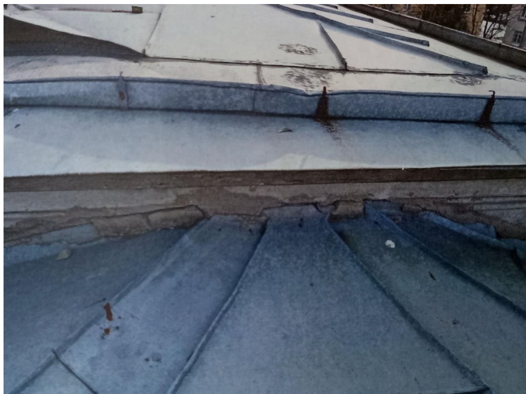
26. Некачественно выполненное примыкание стального кровельного покрытия террасы к стене здания по оси «В». Архив КГИОП. Заключение по результатам технического обследования конструкций крыши здания. Разработано ЗАО «Стройком». 2012 г.
