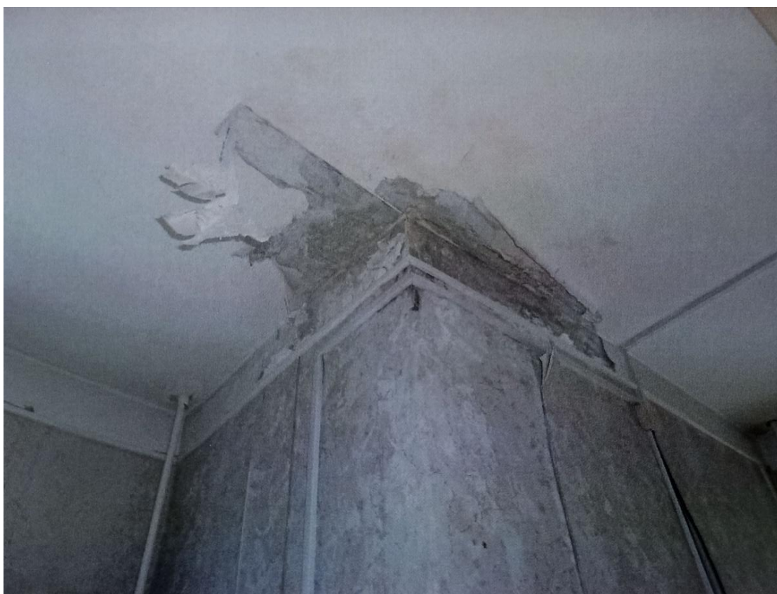
38. Вид протечки в помещении мансарды в осях «В...Д» между осями «4/1...5». Архив КГИОП. Заключение по результатам технического обследования конструкций крыши здания. Разработано ЗАО «Стройком». 2012 г.
