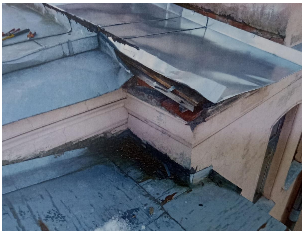
24. Вид неудовлетворительного состояния стального кровельного покрытия в результате некачественного выполнения кровельных работ. Архив КГИОП. Заключение по результатам технического обследования конструкций крыши здания. Разработано ЗАО «Стройком». 2012 г.
