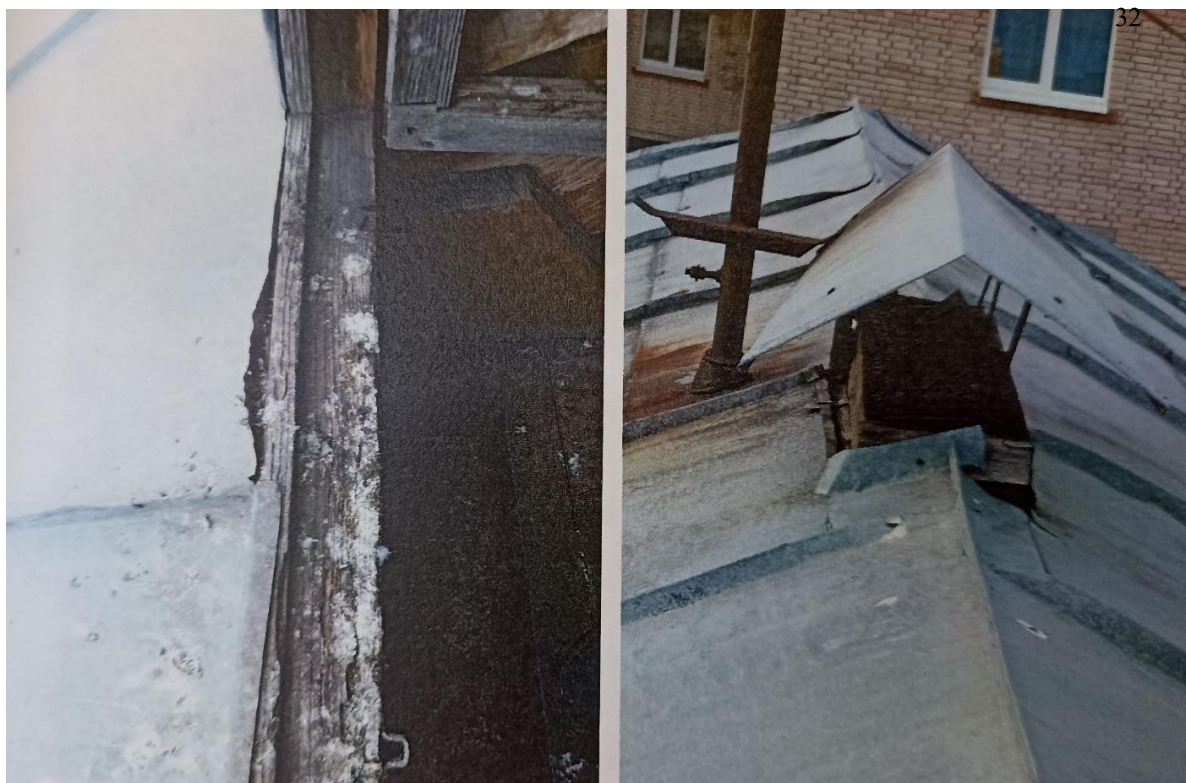
23. Вид некачественно выполненного примыкания стального кровельного покрытия к деревянным конструкциям слухового окна слева и к коньковому продоху справа. Архив КГИОП. Заключение по результатам технического обследования конструкций крыши здания. Разработано ЗАО «Стройком». 2012 г.
