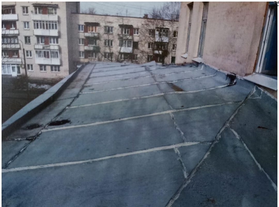
29. Вид крыши в осях «В...И» между осями «5...6» с механическими повреждениями. Архив КГИОП. Заключение по результатам технического обследования конструкций крыши здания. Разработано ЗАО «Стройком». 2012 г.
