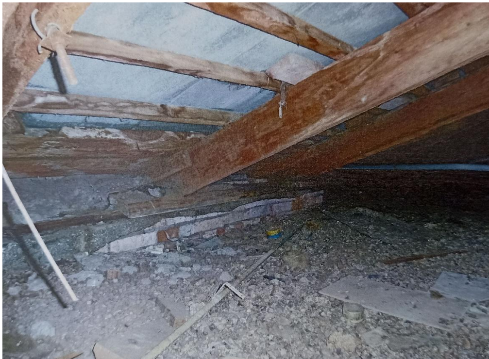
35. Вид опирания стропильной ноги на наружную стену по оси «Г/1» между осями «2/1...2/2» (смещение незакрепленной дощатой прокладки). Архив КГИОП. Заключение по результатам технического обследования конструкций крыши здания. Разработано ЗАО «Стройком». 2012 г.
