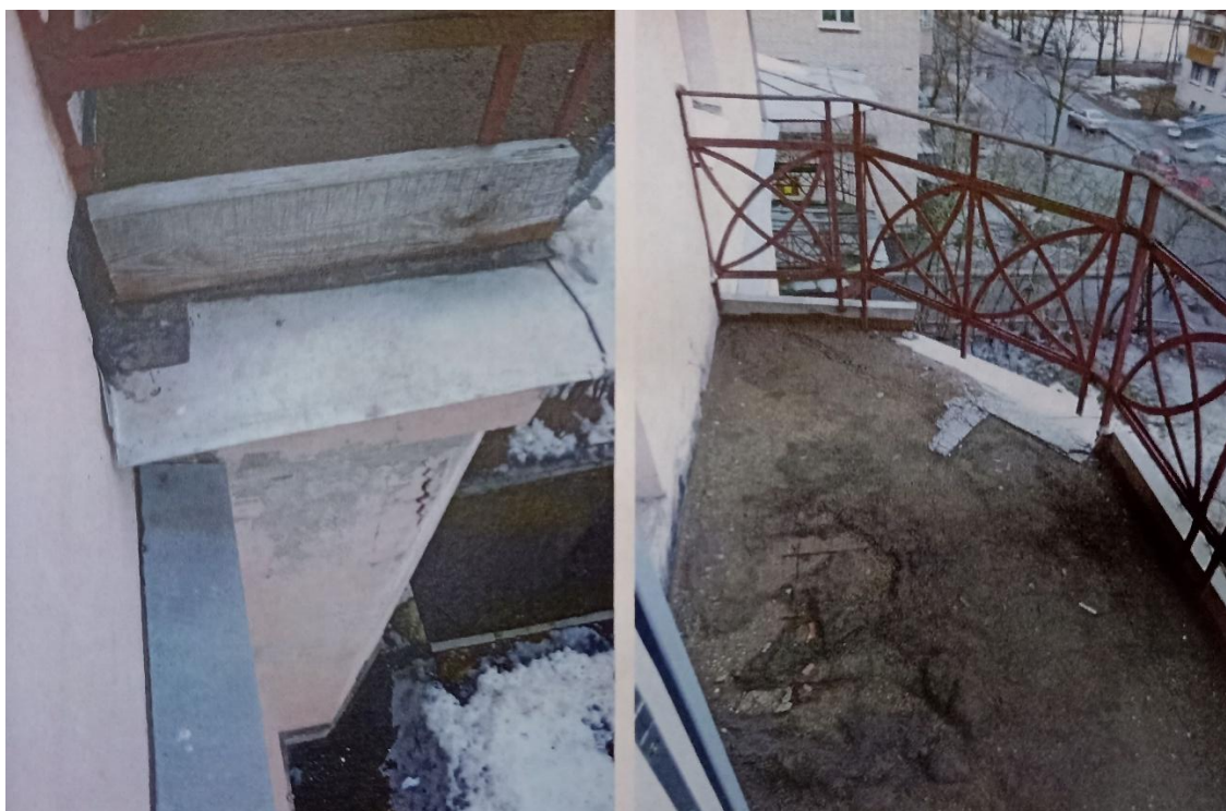
32. Некачественное исполнения гидроизоляционных работ покрытия балкона над эркером слева, состояние цементно-песчаной стяжки, уложенной при отрицательной температуре без прогрева, утепления и анти-морозных добавок, справа. Архив КГИОП. Заключение по результатам технического обследования конструкций крыши здания. Разработано ЗАО «Стройком». 2012 г.
