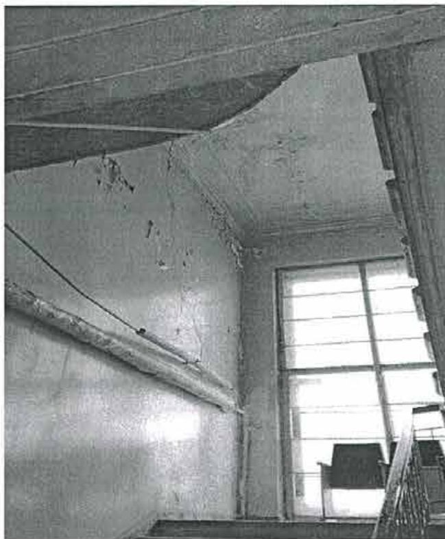
24. Общий вид верхней площадки лестницы и плафона со следами протечек.
