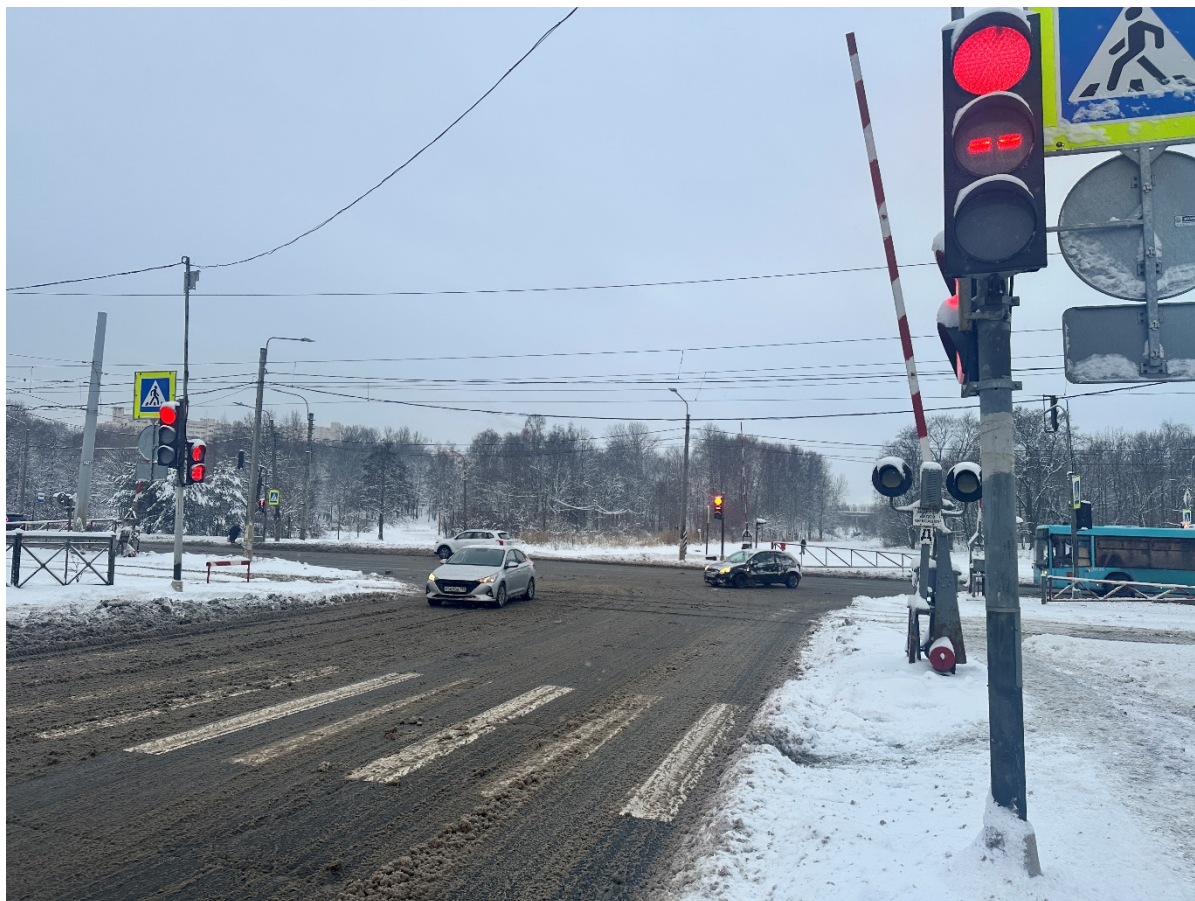
Фото 3. Общий вид на светофорный объект. Дата фотофиксации: 15.12.2024г.
