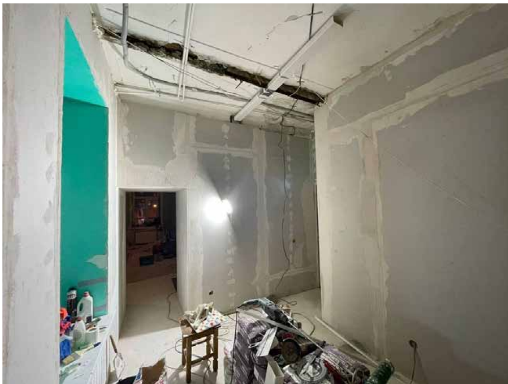
Фото 29. Интерьер квартиры № 4 объекта культурного наследия регионального значения «Доходный дом А.Г. Покровской (Я.И. Шика)»
