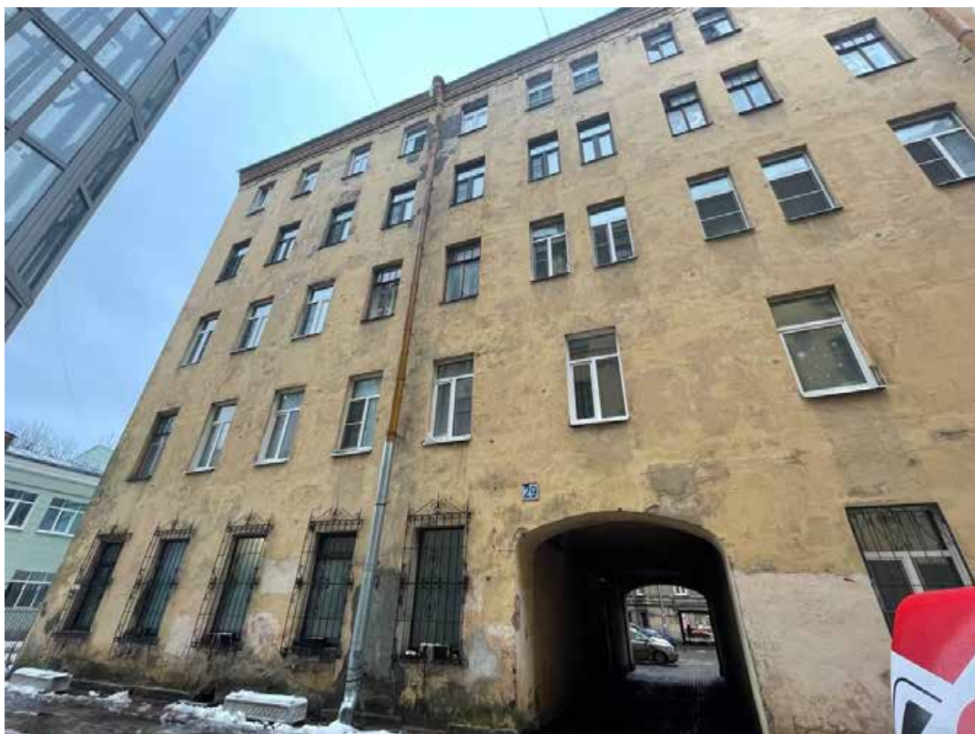
Фото 7. Фрагмент дворового фасада объекта культурного наследия регионального значения «Доходный дом А.Г. Покровской (Я.И. Шика)»
