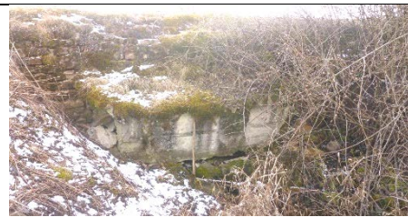
фрагменты кирпичной кладки
