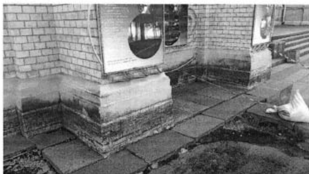
Фото 4. Состояние цоколя северного фасада объект культурного наследия
