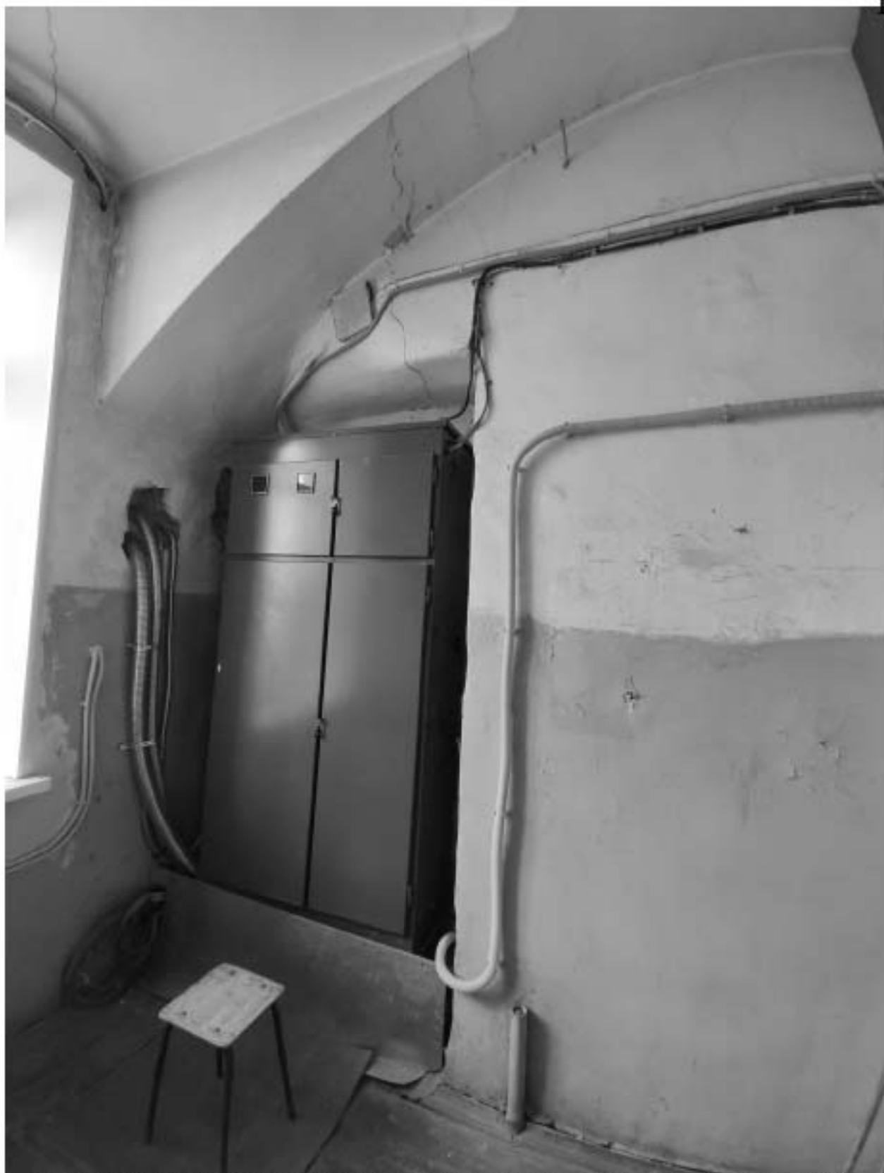
Фото 25. Помещение электрощитовой в уровне 1-го этажа. Дата фотофиксации: 02.12.2024г.
