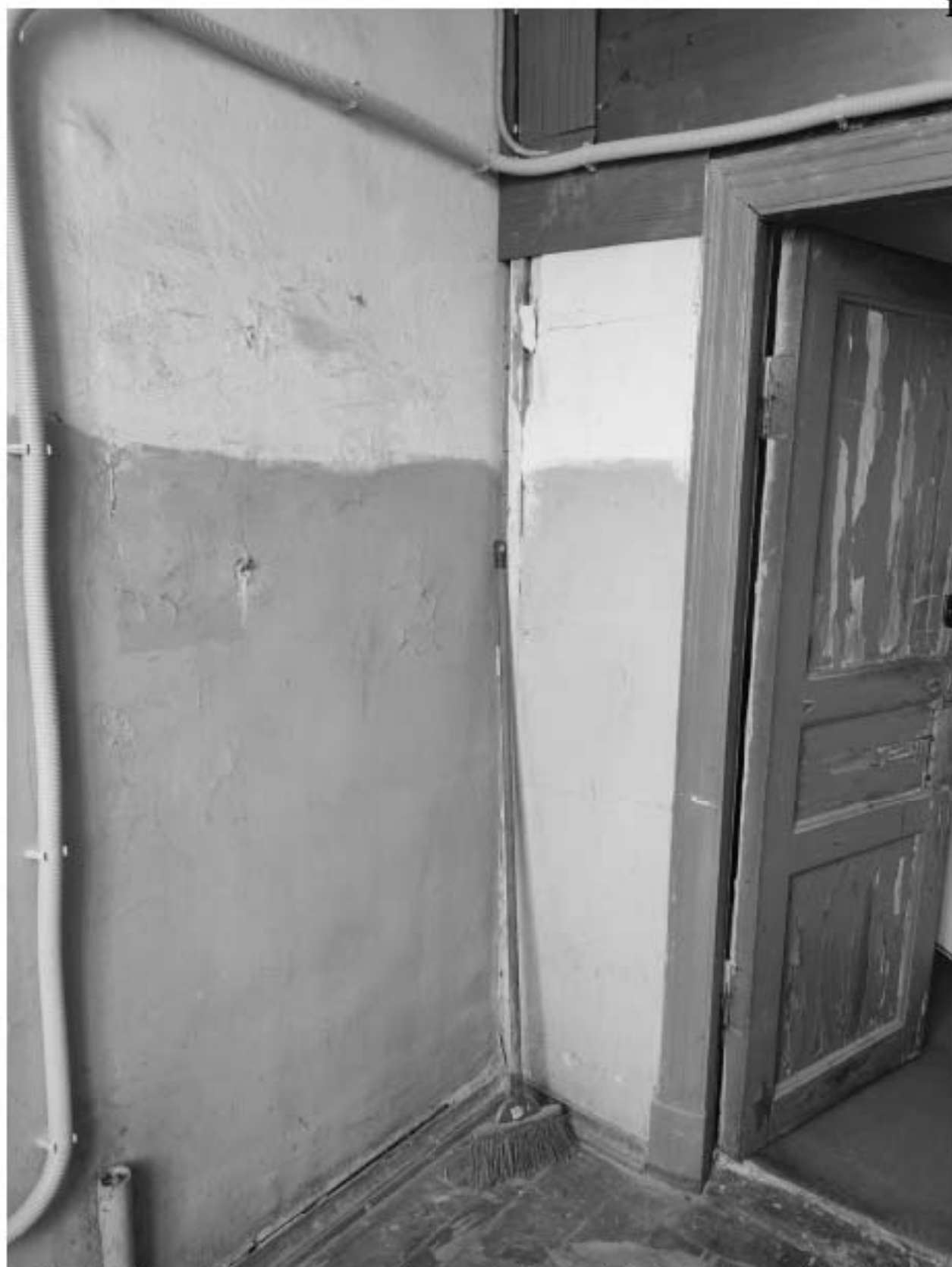
Фото 26. Помещение электрощитовой в уровне 1-го этажа. Дата фотофиксации: 02.12.2024г.
