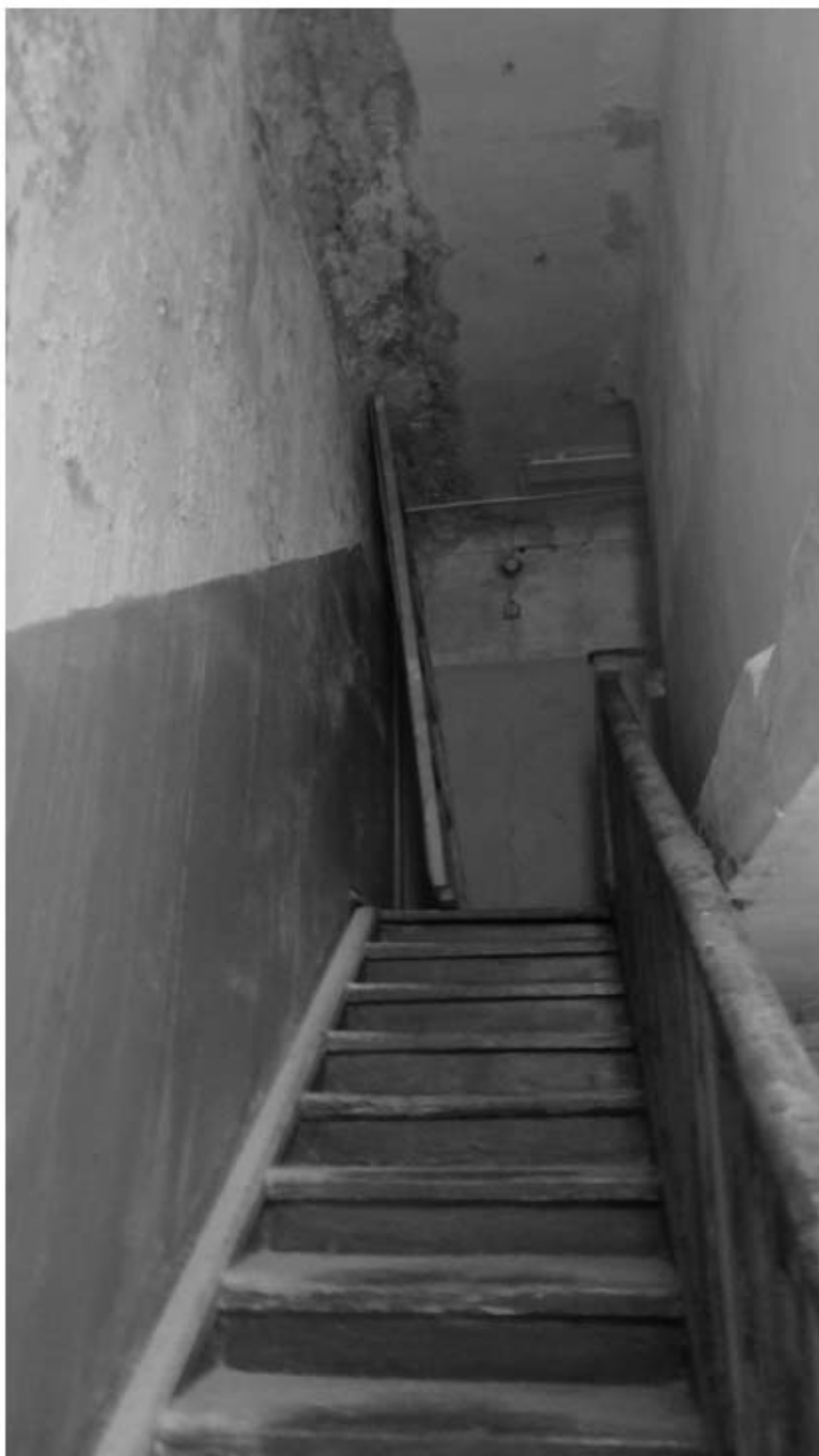
Фото 80. Помещение лестницы в уровне 3-го этажа. Дата фотофиксации: 02.12.2024г.
