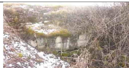
фрагменты кирпичной кладки
