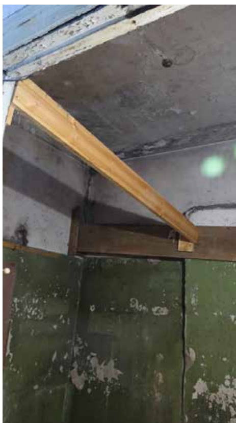
Фото 235. Помещение 136. Потолок. Третий этаж. Дата фотофиксации: 01.03.24
