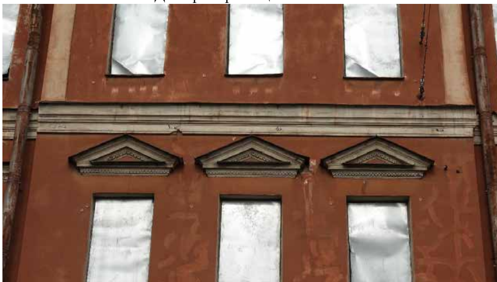
Фото 8. Треугольные профилированные сандрики южного фасада. Дата фотофиксации: 01.03.24
