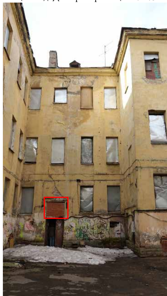
Фото 28. Заложенная фрамуга на дверь к лестнице Л4. Вид со стороны двора.
