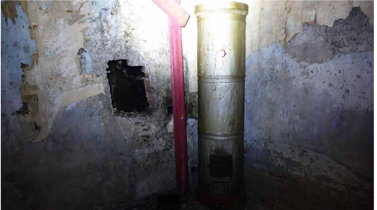
Фото 66. Помещение 33. Дымоход. Первый этаж. Дата фотофиксации: 01.03.24
