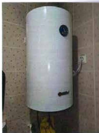
Фото 70. Электрический водонагреватель, установленный в Части 3 (в ч.п. 11 помещения 24-Н).
