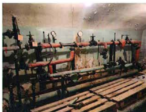
Фото 53. Индивидуальный тепловой пункт в Части 1 (в ч.п.4 помещения 11-Н на цокольном этаже).
