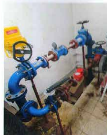
Фото 80. Водомерный узел в Части 4 (на 1-ом этаже в ч.п. 1 помещения 72-Н).
