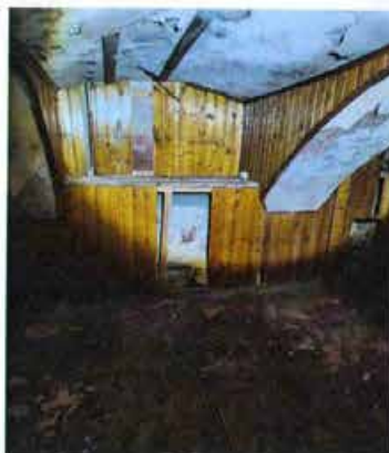
Фото 64. Общая стена между Частью 1 и Частью 3 (линия раздела 2) на цокольном этаже в ч.п. 25 помещения 3-Н (Часть 1).
