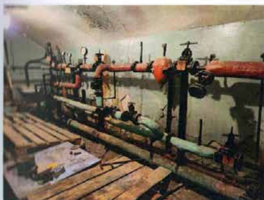
Фото 52. Индивидуальный тепловой пункт в Части 1 (в ч.п.4 помещения 11-Н на цокольном этаже).
