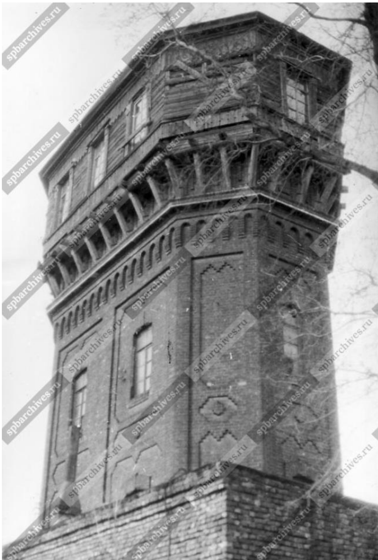
Илл. 31. Вид части кирпичного корпуса водонапорной башни на улице Шкиперский проток., 25 корп 2. 10.05.1991 г. (источник: ЦГАКФФД СПб. Фотодокументы. Опись 1АР-154. Ед.хр.217564).
