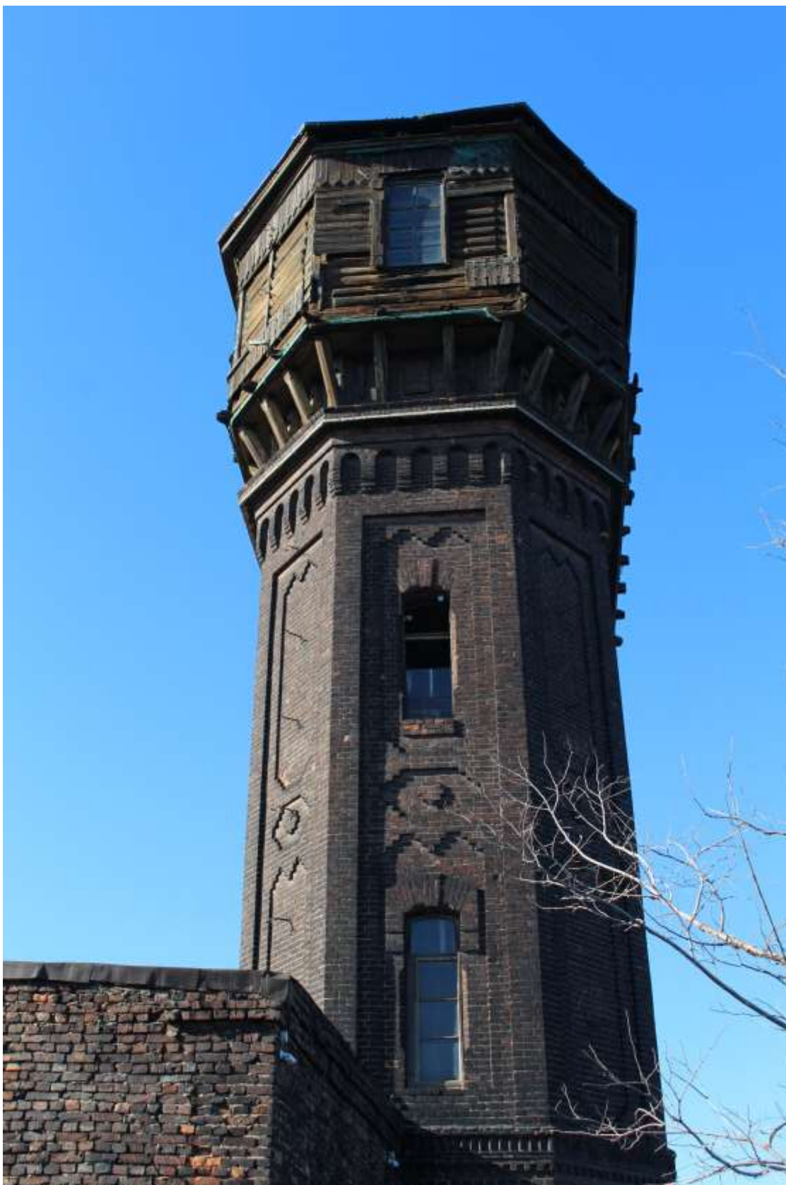
Фото 16. Вид на южный фасад башни объекта культурного наследия федерального значения «Башня водонапорная».
