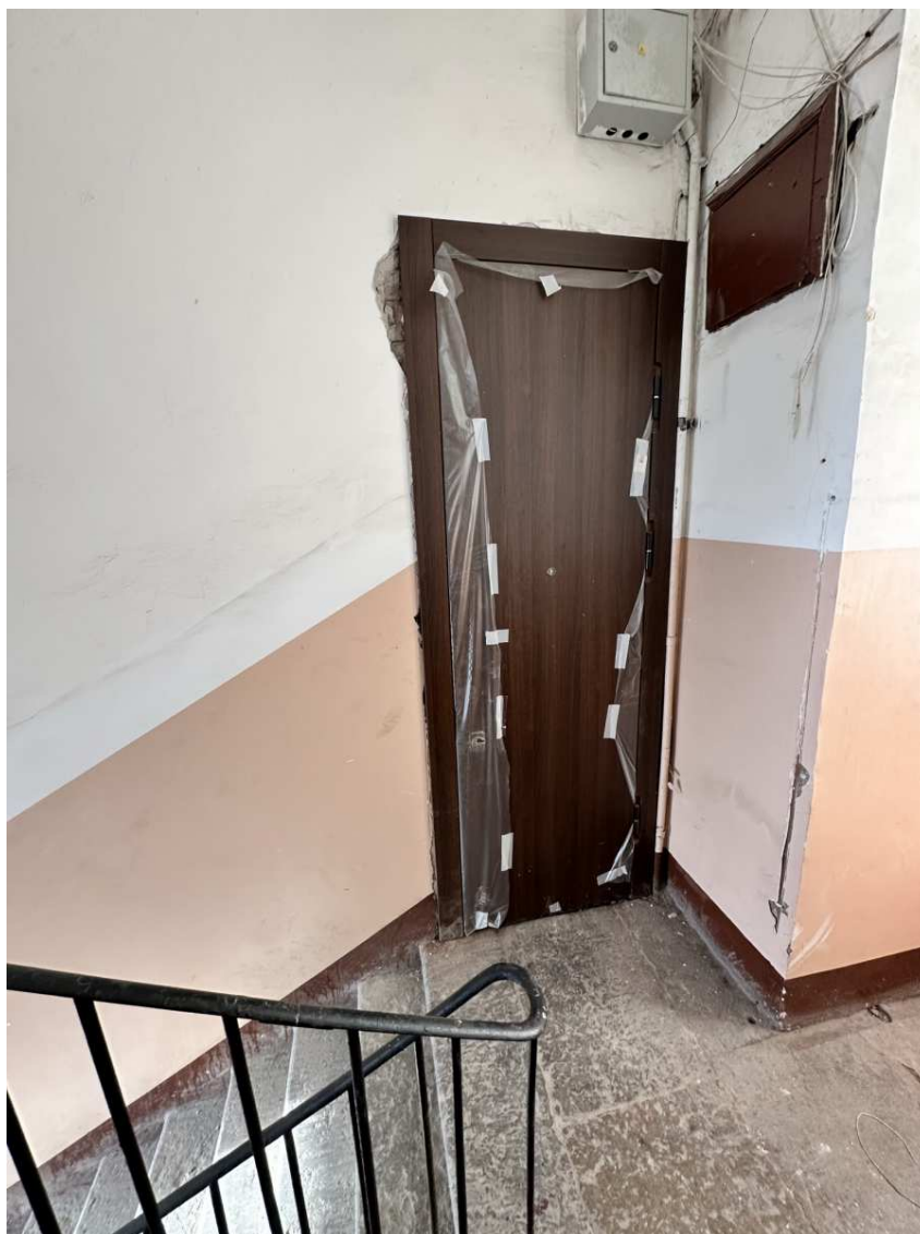
18. Входная дверь в квартиру;
