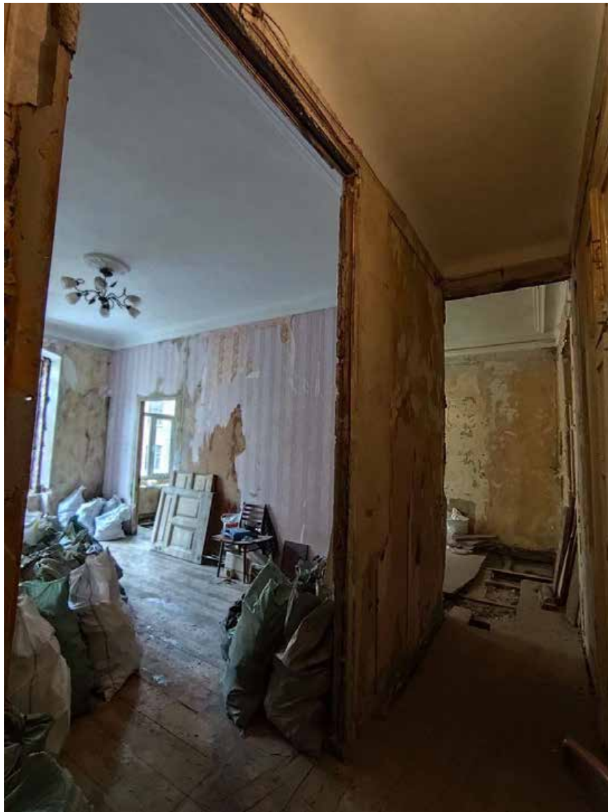
Фото 25. Квартира №32, помещение №1 и №5.
