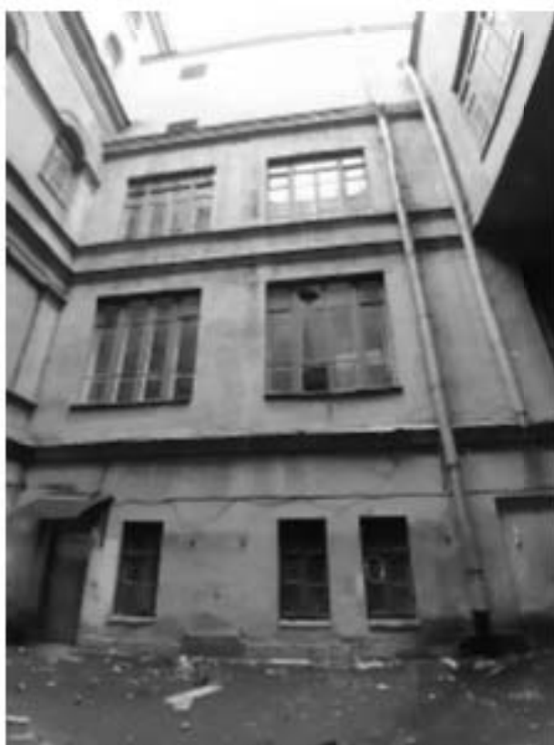
54. «Дума городская с башней (1752-1753 гг., 1799-1804 гг., арх. Феррари Д. 1848-1852 гг., арх. Ефимов Н.Е., 1913-1914 гг., арх. Кенель А.В.)», ул. Думская, д 1-3, лит. А, Невский проспект. Дворовый фасад. Общий вид. Фото 17.10.2023г.
