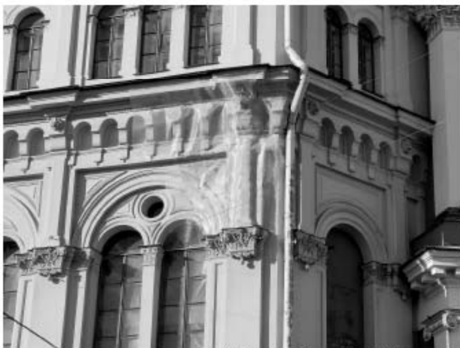
18. «Дума городская с башней (1752-1753 г.г., 1799-1804 г.г., арх. Феррари Д. 1848-1852 г.г., арх. Ефимов Н.Е., 1913-1914 г.г., арх. Кенель А.В.)», ул. Думская, д 1-3, лит. А, Невский проспект. Восточный фасад. Фрагмент. Фото 17.10.2023г.
