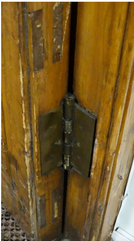
Фото 9. Фурнитура дверей – дверная петля боковой створки. Дата фотофиксации: 11.12.2023
