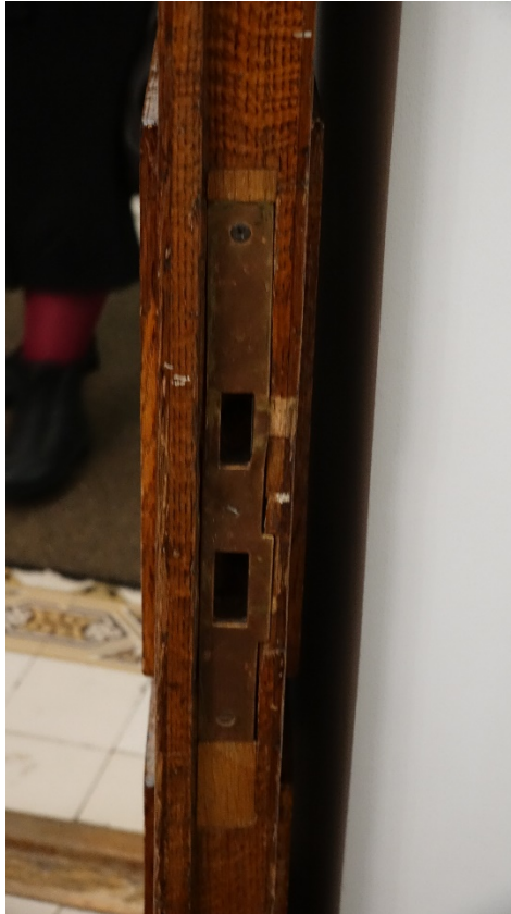
Фото 21. Фурнитура дверей – фрагменты замкового механизма боковой створки. Дата фотофиксации: 11.12.2023
