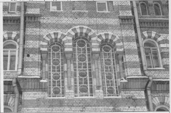
32. Западный фасад западного корпуса с колокольней. Окно ризалита лестничной клетки парадной лестницы.
