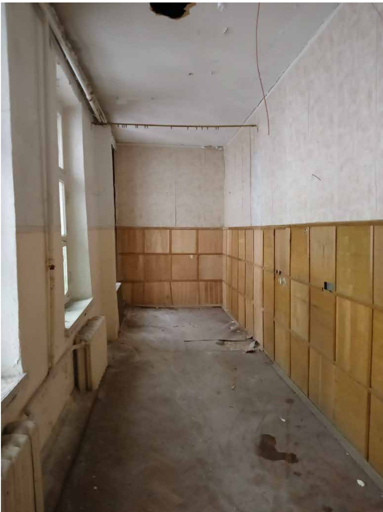
Фото 13. Объект культурного наследия федерального значения «Храм евангелическо-лютеранский Апостола Петра», Санкт-Петербург, Невский проспект, дом 22-24, литеры А, Б, Ж, дом 22а, литера А. Флигель (лит.Ж). Помещение 33-Н (6).
