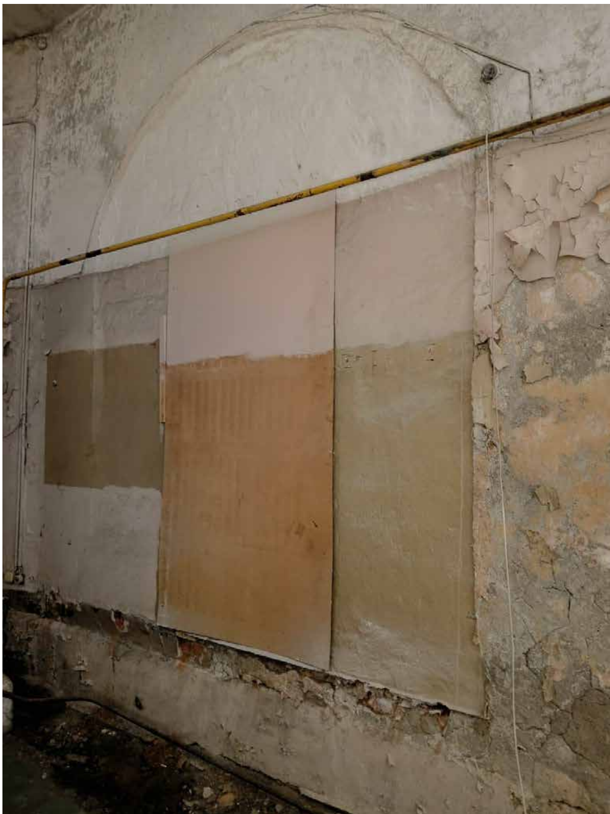
Фото 9. Объект культурного наследия федерального значения «Храм евангелическо-лютеранский Апостола Петра», Санкт-Петербург, Невский проспект, дом 22-24, литеры А, Б, Ж, дом 22а, литера А. Флигель (лит.Ж). Помещение 33-Н (2). В ниже первоначального, заложенного, оконного проема устроен дверной проем, закрыт фанерой.
