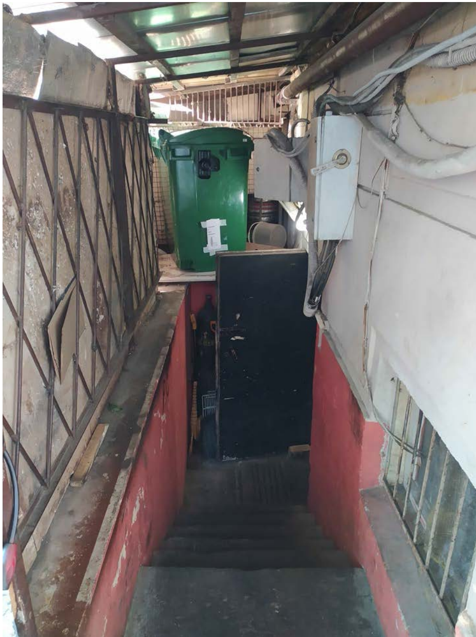
20. Выявленный ОКН «Дом Ведомства учреждений императрицы Марии» по адресу: г. Санкт-Петербург, Казанская ул., д. 5, литера А. Дворовой фасад лицевого корпуса. Вход в помещение 7-Н через приямок. Фотофиксация от 03.10.2023 г.
