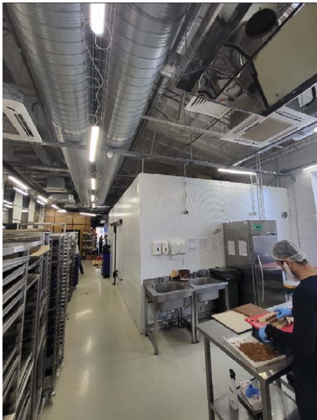
Фото №75. Вид на морозильный камеры. Помещение №85 согласно экспликации.
