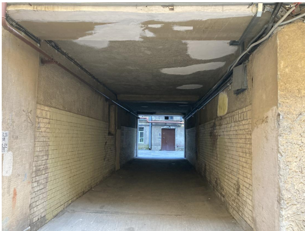
Фото 9. Фрагмент дворового фасада выявленного объекта культурного наследия «Дом Н.И. Алексеева», воротный проезд во дворе
