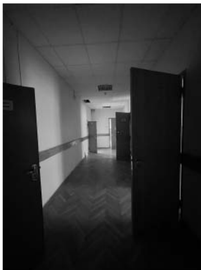
79. Здание по адресу: Санкт-Петербург, Моховая улица, д. 10, строение 1. Коридор 3 этажа. Пом. МОП 1
