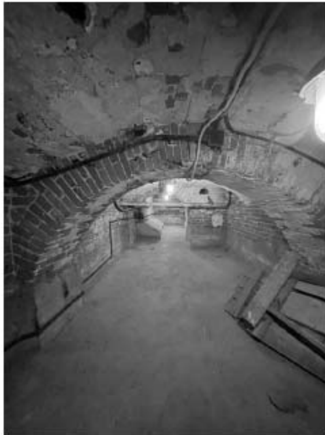
2. Здание по адресу: Санкт-Петербург, Моховая улица, д. 10, строение 1. Подвал (технический этаж). Помещение 1-Н
