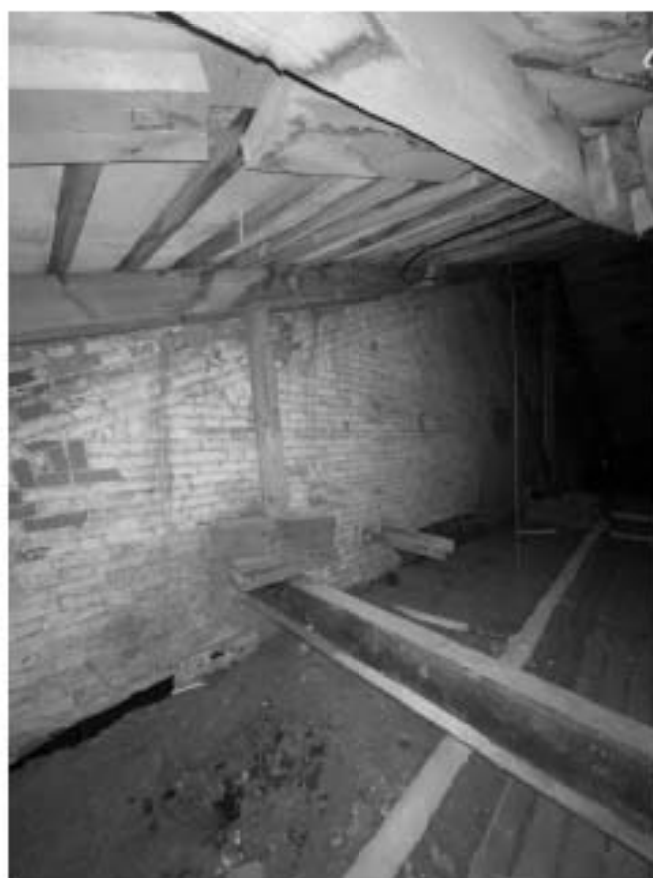
90. Здание по адресу: Санкт-Петербург, Моховая улица, д. 10, строение 1. Чердак
