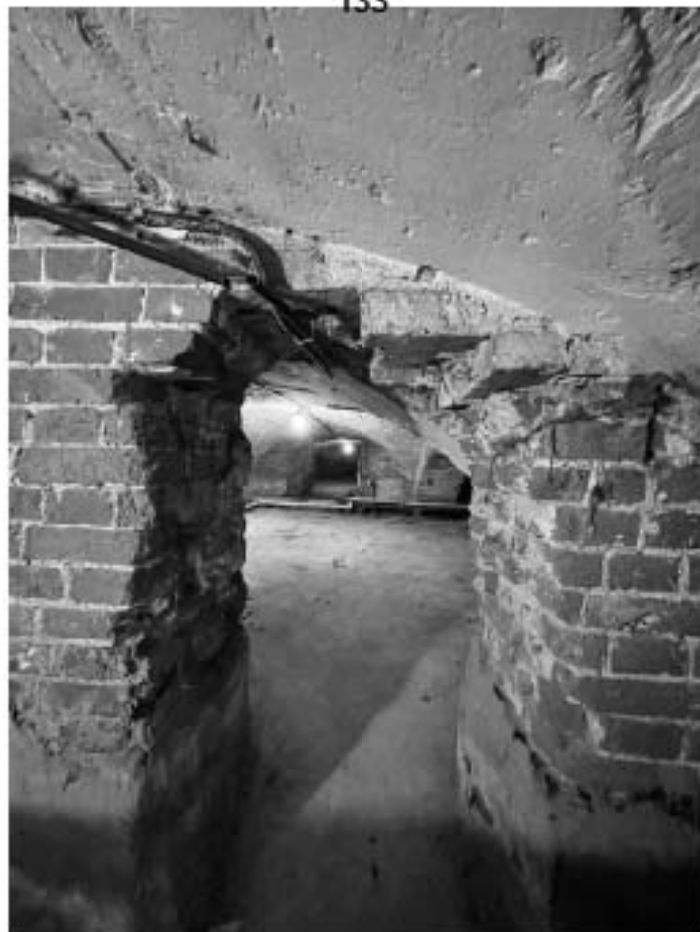
13. Здание по адресу: Санкт-Петербург, Моховая улица, д. 10, строение 1. Подвал (технический этаж). Помещение 1-Н
