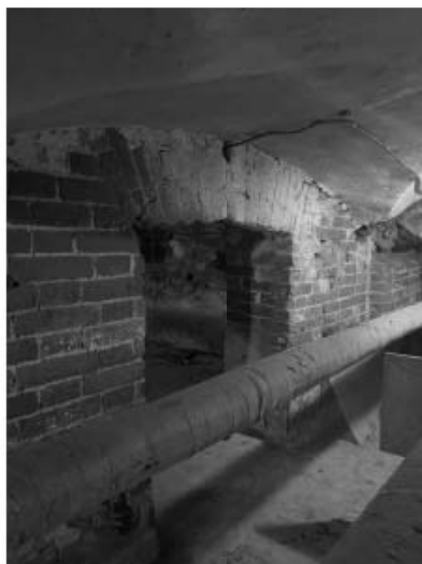
14. Здание по адресу: Санкт-Петербург, Моховая улица, д. 10, строение 1. Подвал (технический этаж). Помещение 1-Н
