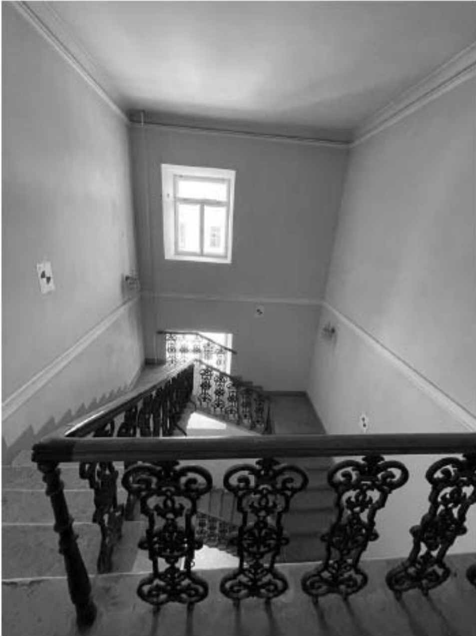
62. Здание по адресу: Санкт-Петербург, Моховая улица, д. 10, строение 1. Главная лестница в уровне 3 этажа. Фрагмент. Пом. МОП 1
