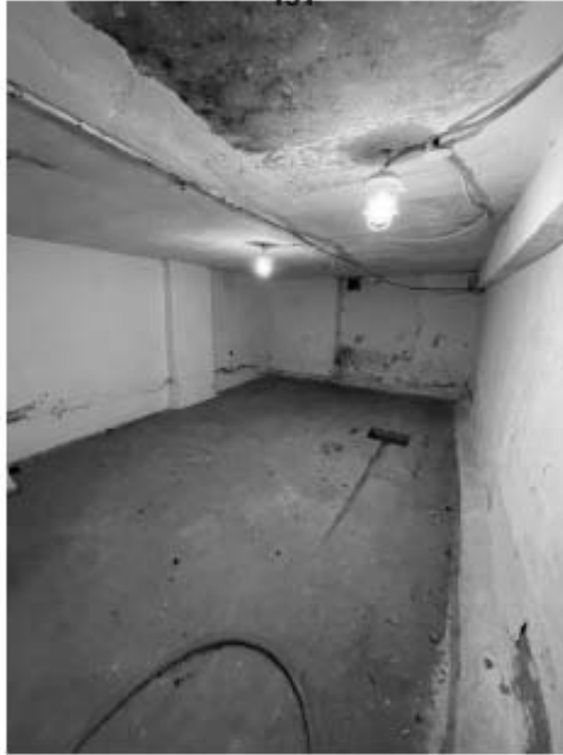
9. Здание по адресу: Санкт-Петербург, Моховая улица, д. 10, строение 1. Подвал (технический этаж). Помещение 1-Н
