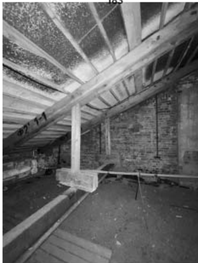
95. Здание по адресу: Санкт-Петербург, Моховая улица, д. 10, строение 1. Чердак
