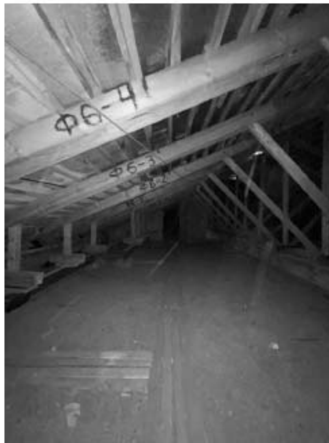
92. Здание по адресу: Санкт-Петербург, Моховая улица, д. 10, строение 1. Чердак
