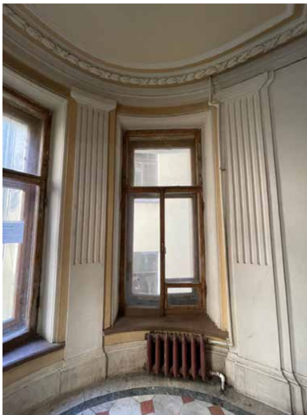
83. Оконный проем круглого ризалита лестничной площадки между четвертым и пятым этажами. Вид в западную сторону.
