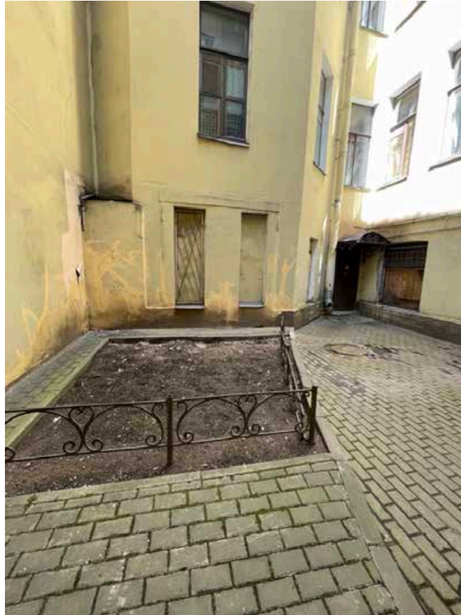
35. Фрагмент западного фасада южного двора. Отделка цоколя известняковой плитой частично утрачена.
