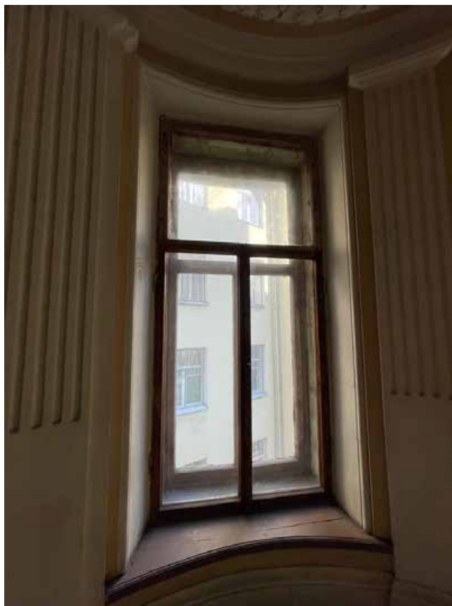
81. Оконный проем круглого ризалита лестничной площадки между четвертым и пятым этажами. Вид в восточную сторону.
