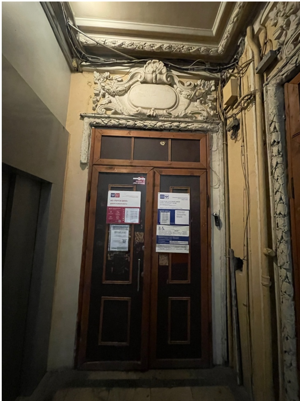
32. Дверной проем в помещение 3-Н(9). Рельефная композиция над дверным проемом в виде картуша аналогичная. Значительные утраты дверного наличника в виде лавровой гирлянды. Плафон потолка также утратил часть карниза и растительной тяги по периметру после устройства лифтовой шахты на всю высоту здания в лестничной клетке.
