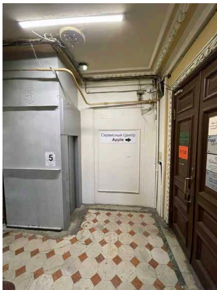
117. Оформление северной стены лестничной площадки пятого этажа утрачено.
