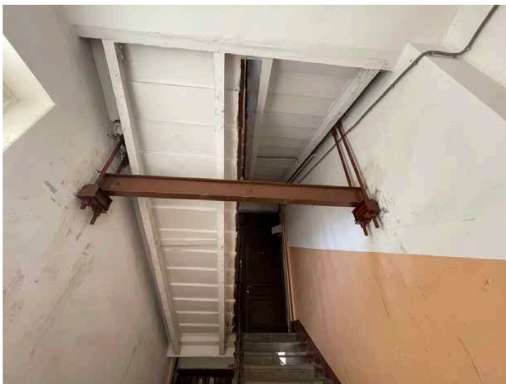
210. Металлическая конструкция усиления (предположительно выполнена после устройства лифта) на уровне шестого этажа лестничной клетки западного фасада.
