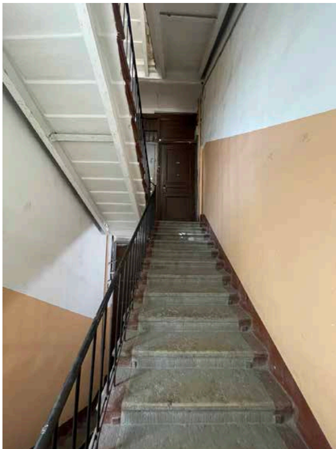
207. Общий вид лестничного марша с четвертого на пятый этаж лестничной клетки западного фасада.
