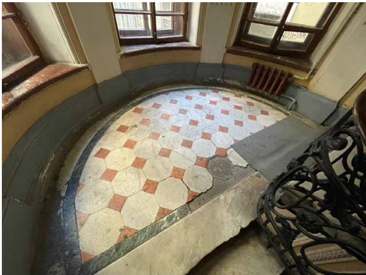
41. Покрытие лестничной площадки между вторым и третьим этажами – метлахская плитка красного и белого цвета, простой бордюр зеленого мрамора. Имеются утраты.
