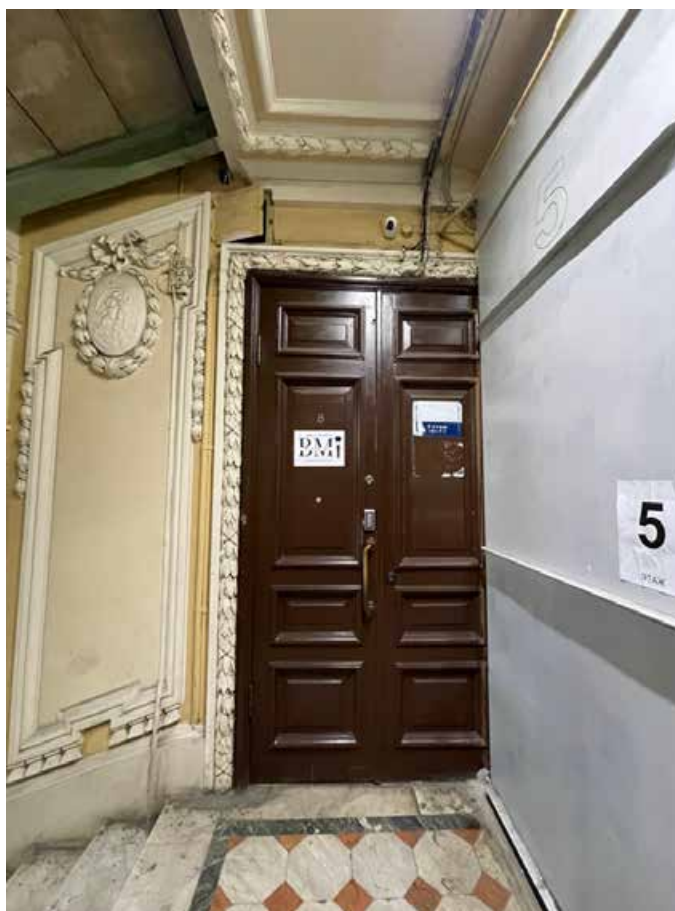
88. Дверной проем в помещение 23-Н(1). Оформление и заполнение проема аналогично проемам и заполнению на этом же этаже. Имеются значительные утраты наличника дверного проема в связи с устройством лифтовой шахты.
