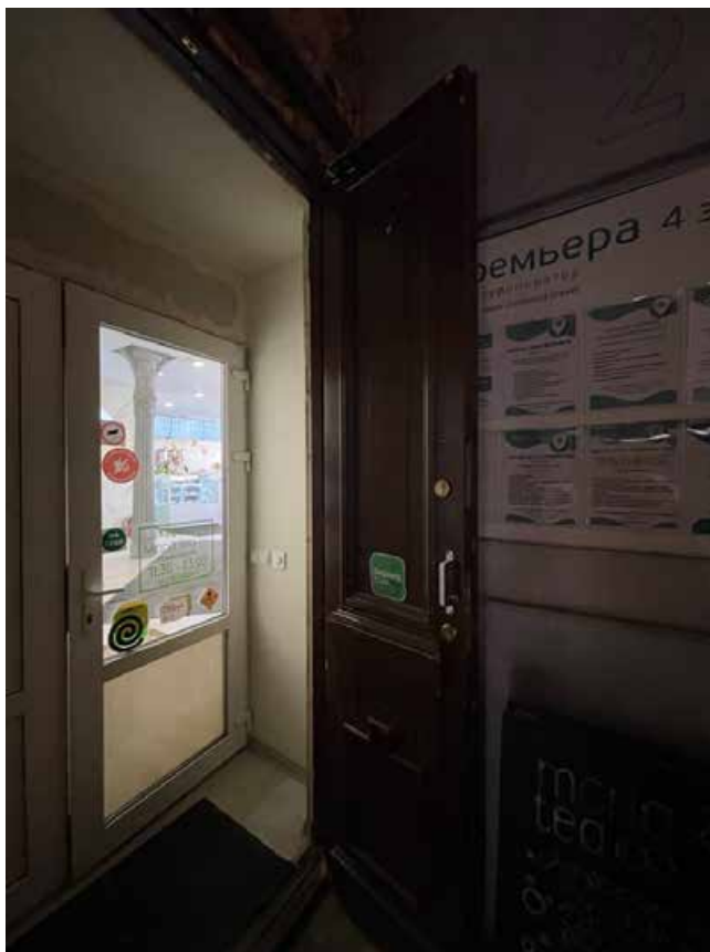
28. Дверной проем в помещение 3-Н(1). Двустворчатое филенчатое деревянное дверное заполнение, каждая створка делится на три филенки.
