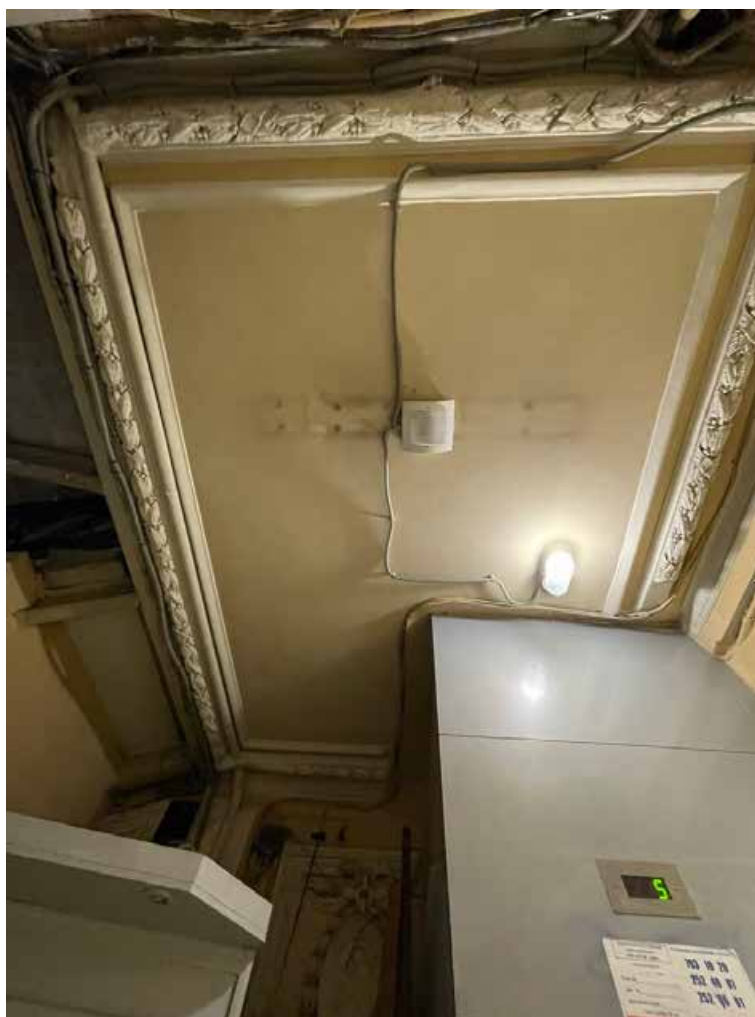
10. Потолок лестничной площадки оформлен профилированным карнизом и лавровой гирляндой, аналогичной гирлянде дверного проема. В месте установки лифтовой шахты гирлянда и профилированный карниз утрачены.
