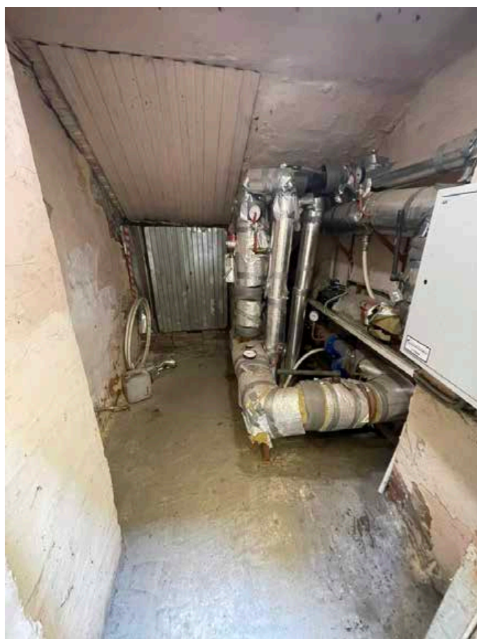
216. Общий вид помещения ИТП под лестницей южного фасада. Помещение 8-Н, вход со стороны южного двора.
