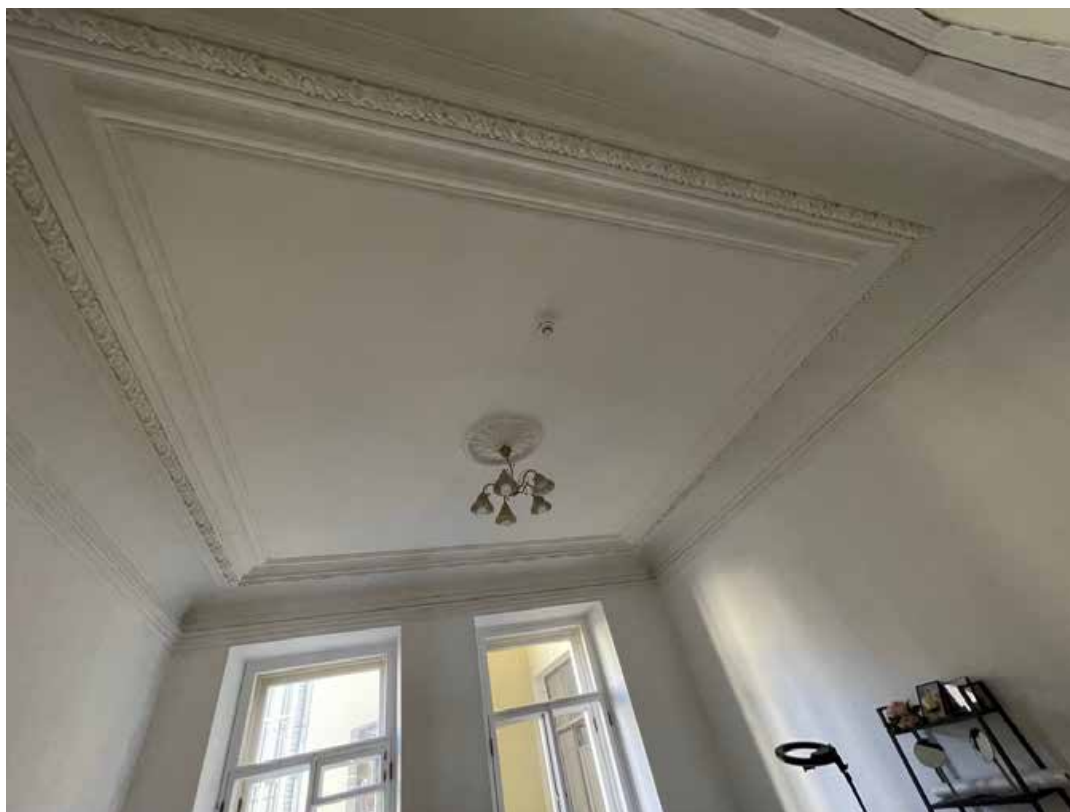
90. Общий вид оформления потолка помещения 23-Н(3): многоуровневый профилированный карниз с падугой и карнизом в виде гирлянды растительного мотива. Розетка в центре потолка поздняя.
