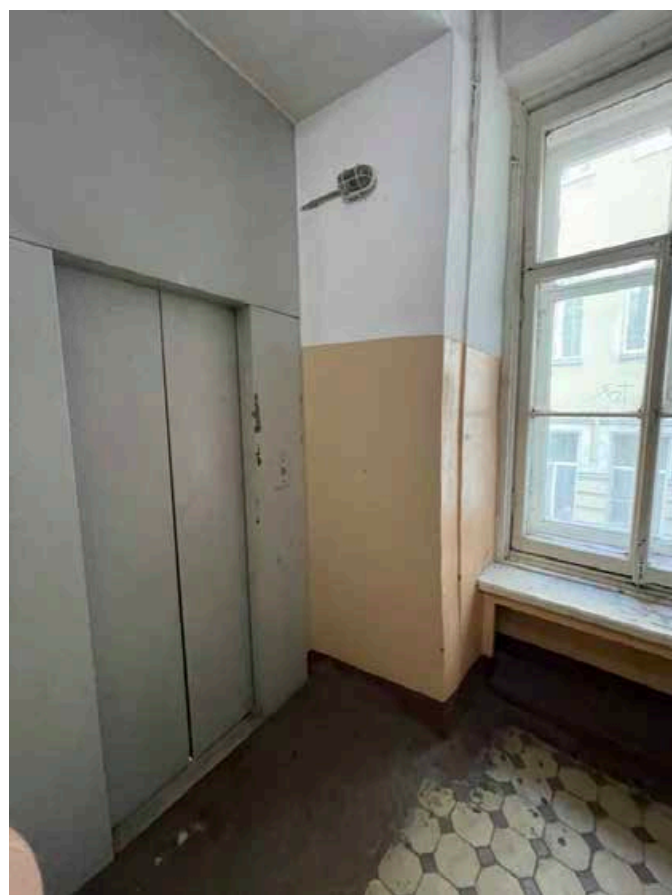
202. Вид лифтовой шахты на площадке между вторым и третьим этажами лестничной клетки западного фасада.
