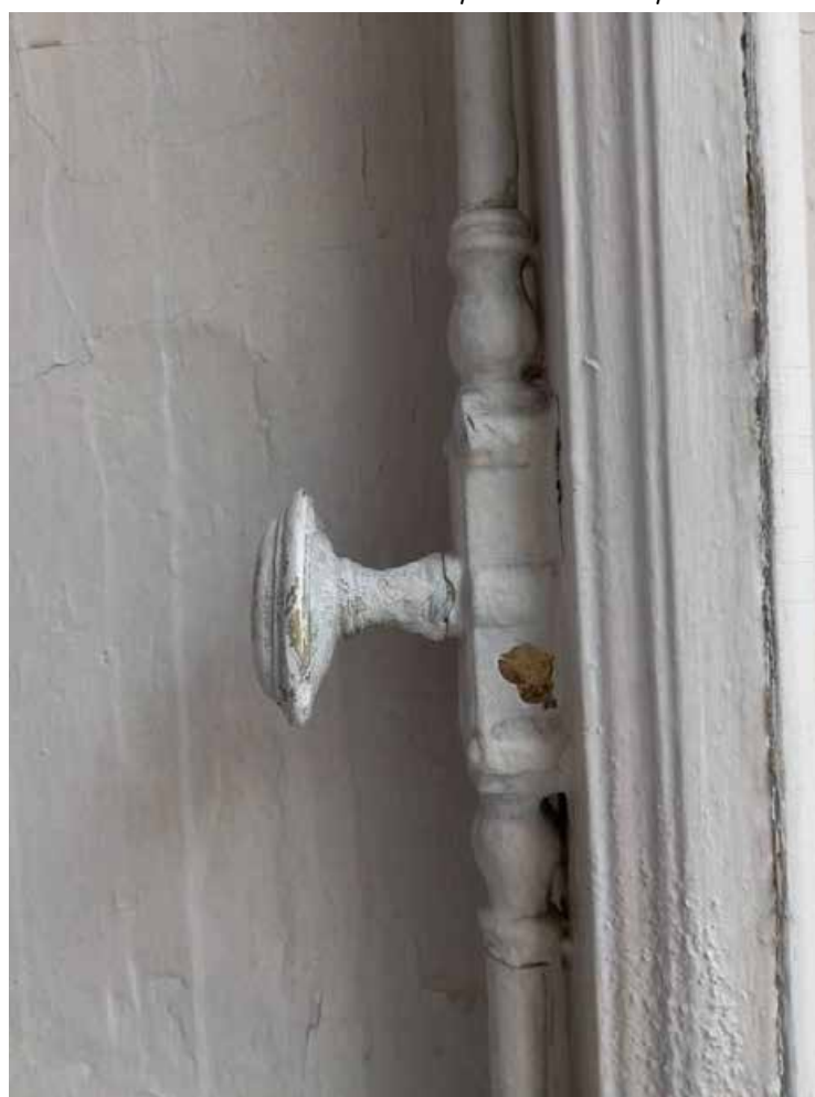
Фото 24. Фурнитура. Наблюдаются следы многочисленных покрасок, вмятины
