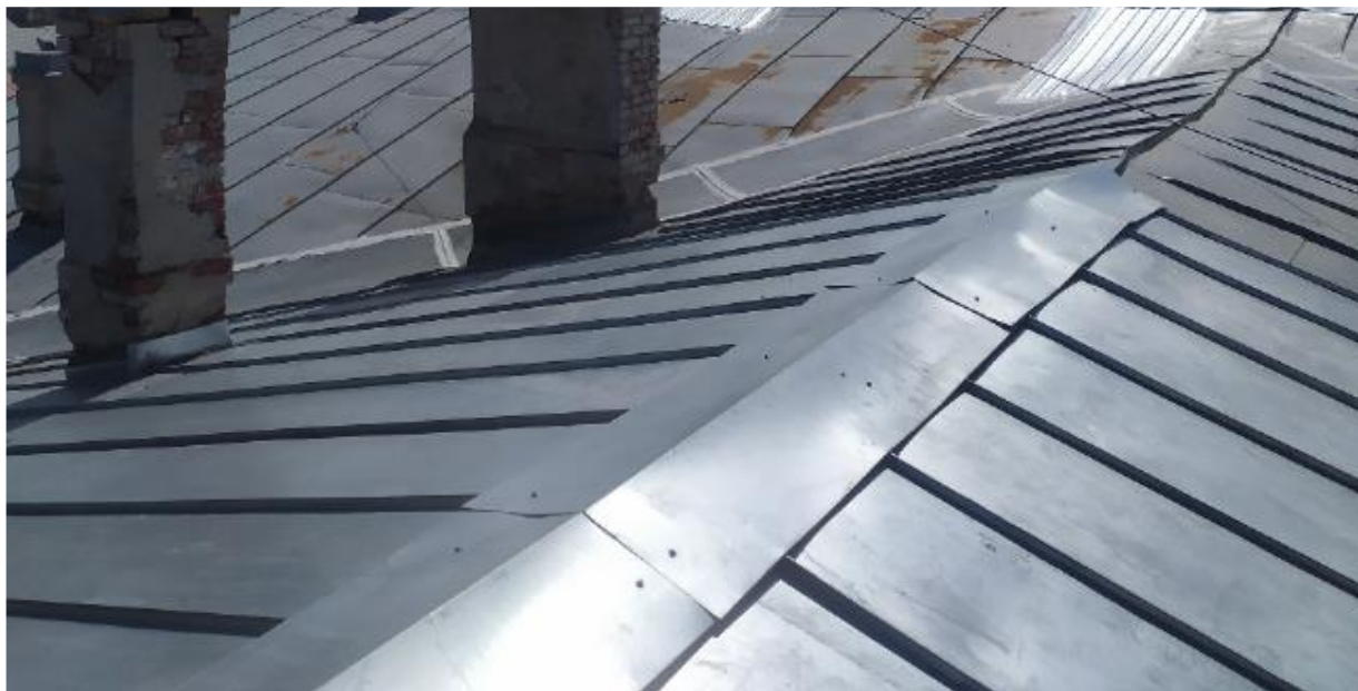
Фото 30. ОКН регионального значения «Духовная академия» (наб. Обводного канала, 7, литер Г). Крыша. Фрагмент. Съёмка 22.03.2021 г.
