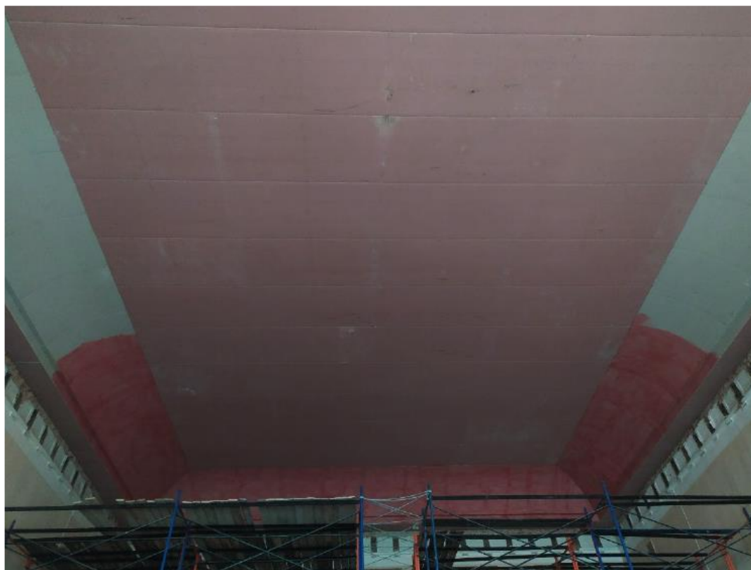
Фото 27. ОКН регионального значения «Духовная академия» (наб. Обводного канала, 7, литер Г). Стропильная система в осях А-Е/10-11. Съёмка 22.03.2021 г.
