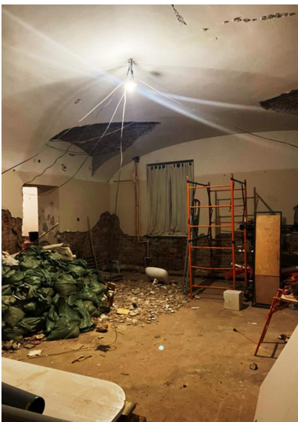
4. «Бывш. Дом Бутурлиной», ул. Чайковского, д.10, лит. А. 1 этаж. Квартира №61. Помещение №1. Общий вид. Фото 26.10.2023г.
