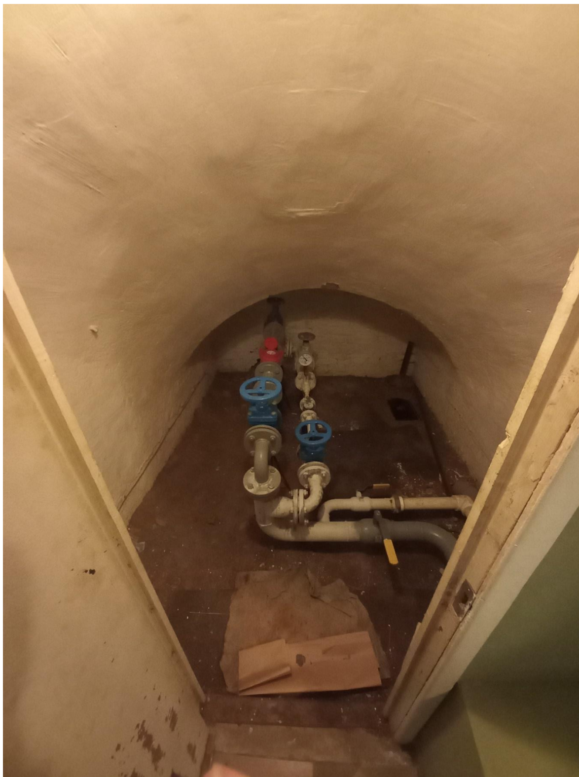
Фото 4. Помещение 6. Водомерный узел.
