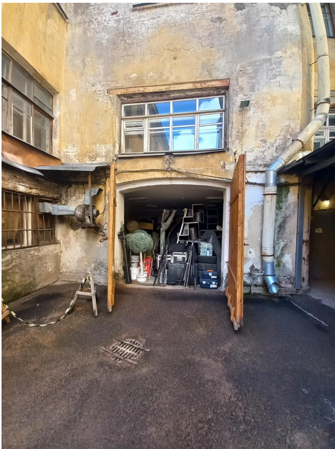
Фото 2. Здание литер Б. Северная часть дворовой территории. Вход в пом. №7 по проектной экспликации.
