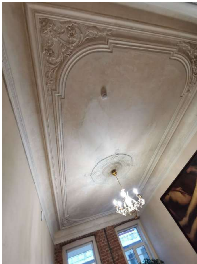
Фото 21. Профилированная лепная широкая падуга, оформление потолка лепным зеркалом с декорированными углами орнаментальными цветочными композициями и потолочной розеткой.
