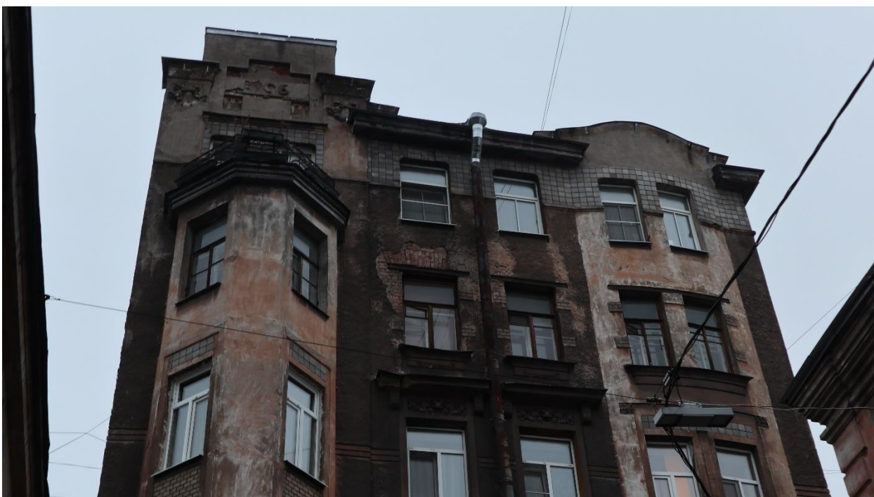
Фото 2. Лицевой фасад здания. Утраты декоративной отделки
