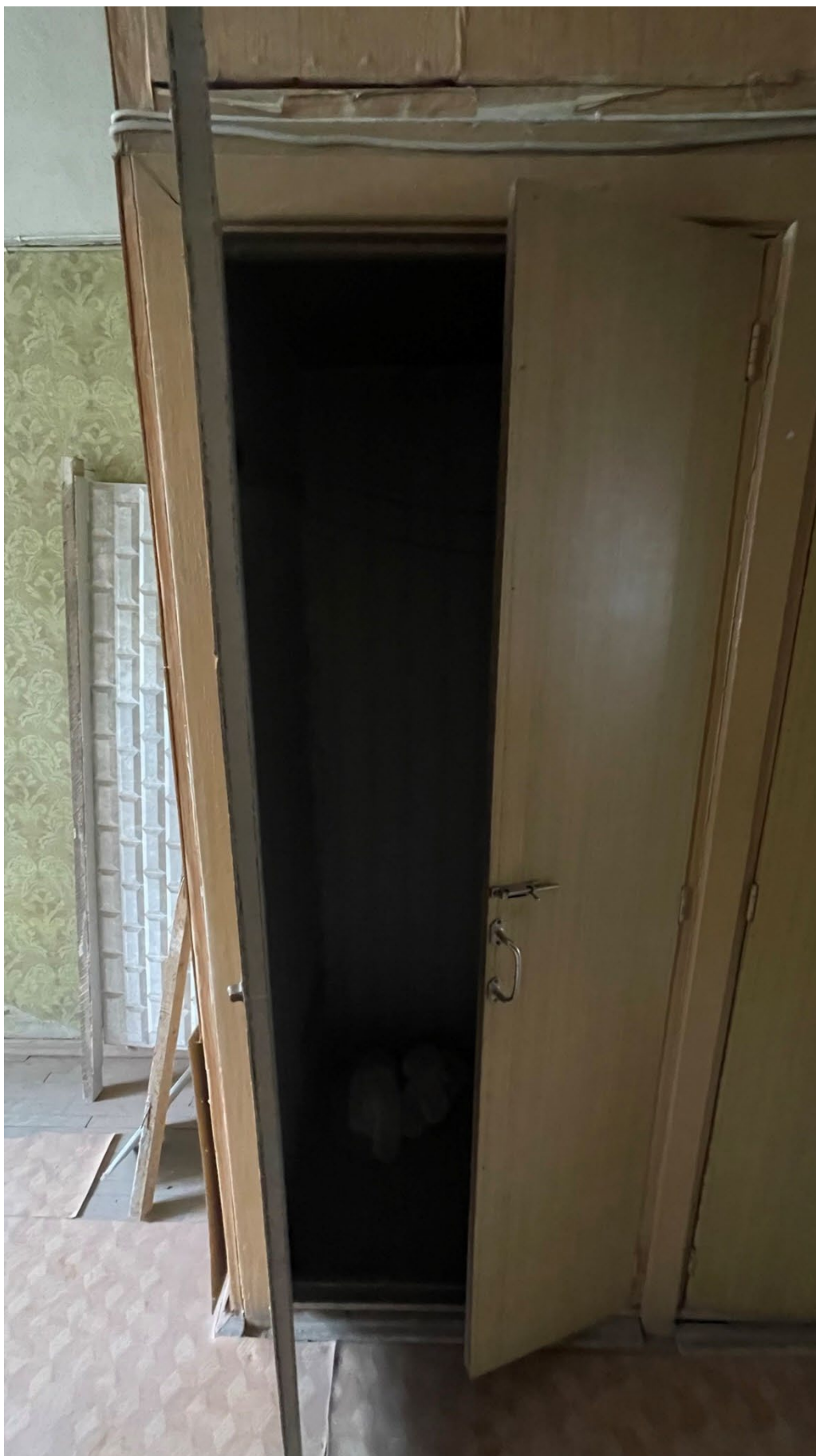
9. Вид на шкаф (помещение 2);
