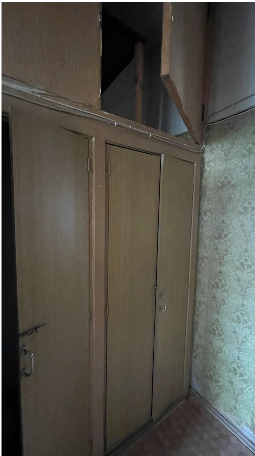
10. Вид на шкаф (помещение 3);
